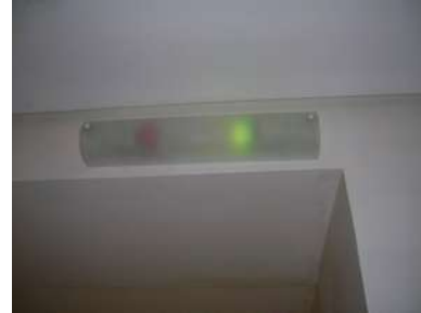
Foto 4.59 - Sinalização de acesso ao acelerador linear.
