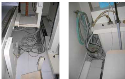
Foto 2.28 - Fios expostos na sala de raio X CD \beta .
