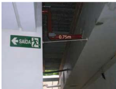
Foto 5.33 - Sinalização de saída.
