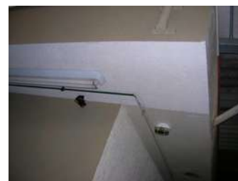
Foto 5.37 - Sinalização rota de fuga por iluminação.
