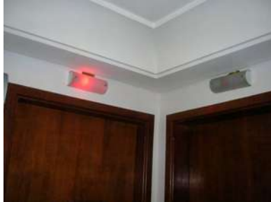
Foto 4.58 - Sinalização de acesso de exames do segundo pavimento.
