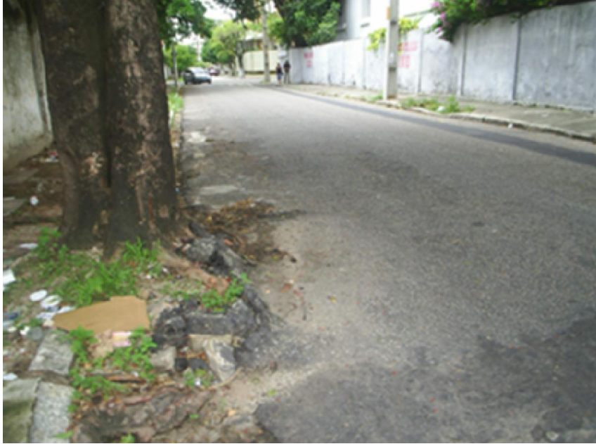
Figura 4.12 – A árvore na Aldeota com afloramento de raízes comprometendo a pista de rolamento (2007)
