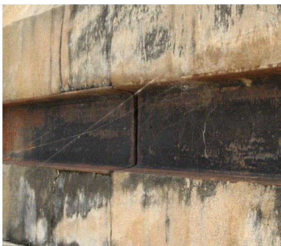
Figura 37: Deslocamento diferencial da guia metálica da grade (muro guia esquerdo)
