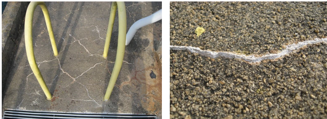
Figura 36: Exsudação de material branco de fissuras
