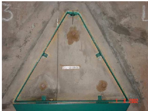
(b) Triangulação instalada em uma parede
