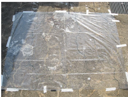
Figura 39: Mapeamento de fissuras na laje
