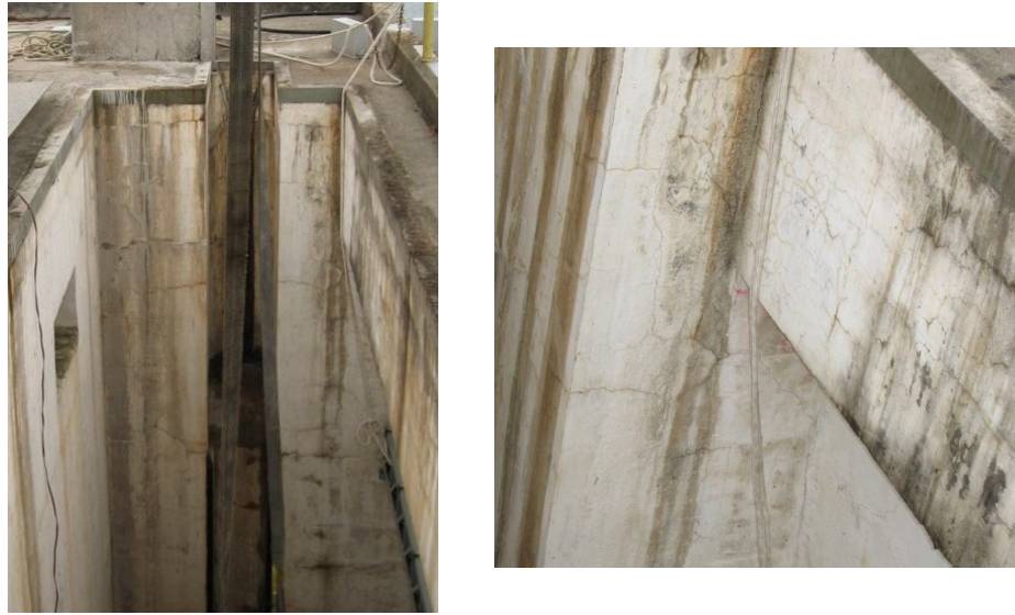
Figura 34: Fissurações nas paredes internas do compartimento do stop-log
