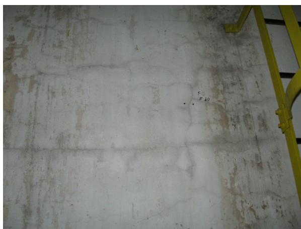
Figura 31: Fissurações aleatórias nas paredes internas da câmara do servomotor
