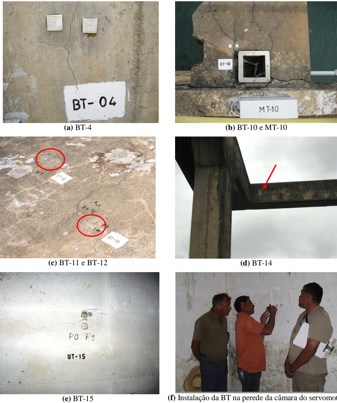
Figura 52: Bases para medição dos movimentos de fissuras instaladas na UHE Jaguari
