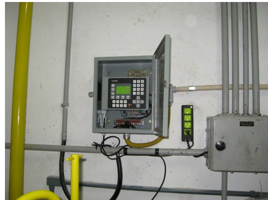
(b) Sistema de aquisição de dados funcionando
