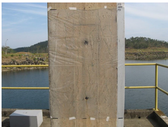
Figura 40: Mapeamento de fissuras no pilar
