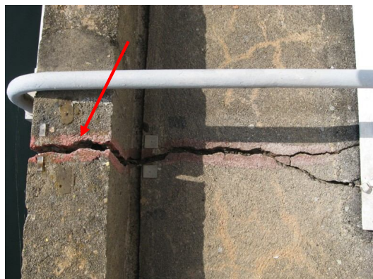
(a) Fissura onde foi instalado o MT-8
