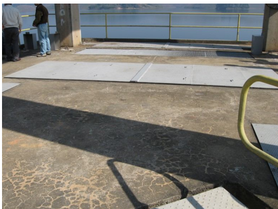
(a) Fissuras aleatórias
