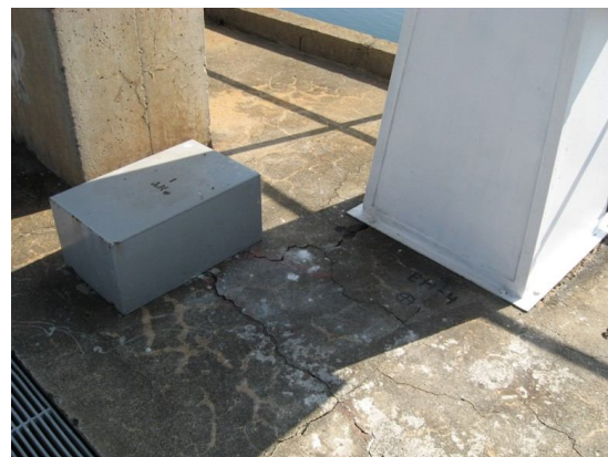
(b) Fissuras orientadas com aleatórias ao redor
