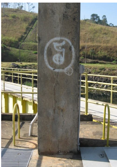
Figura 33: Fissuras verticais nos pilares
