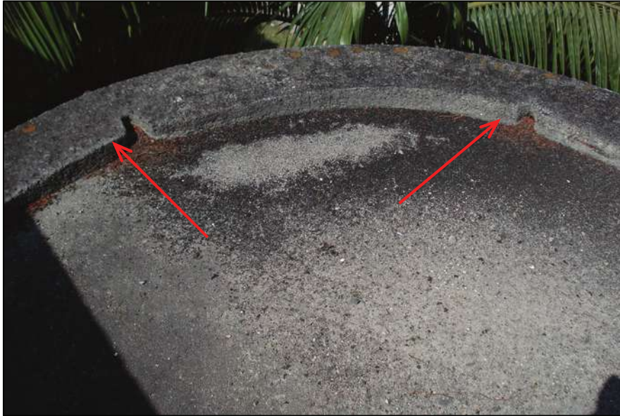
Fig. 4.11. - Vista externa da laje de cobertura da escadaria dos presos, notando-se que as saídas para o escoamento de águas de chuvas estão obstruídas por folhas.
