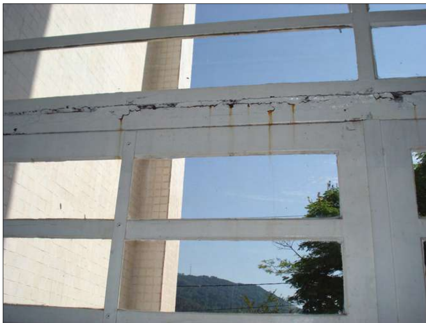
Fig. 5.18. – Degradação da pintura dos caixilhos
