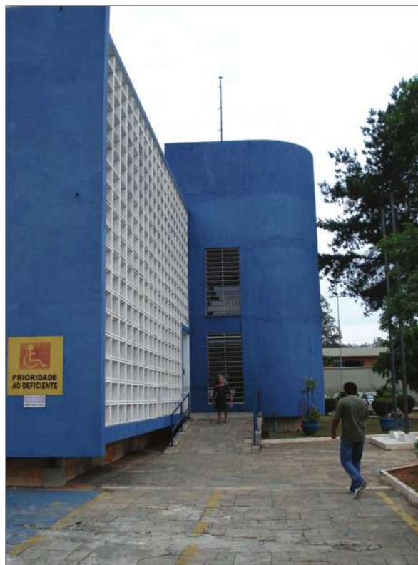
Fig. 6.28. – Pedras de revestimento do piso degradadas Fonte – Autor
