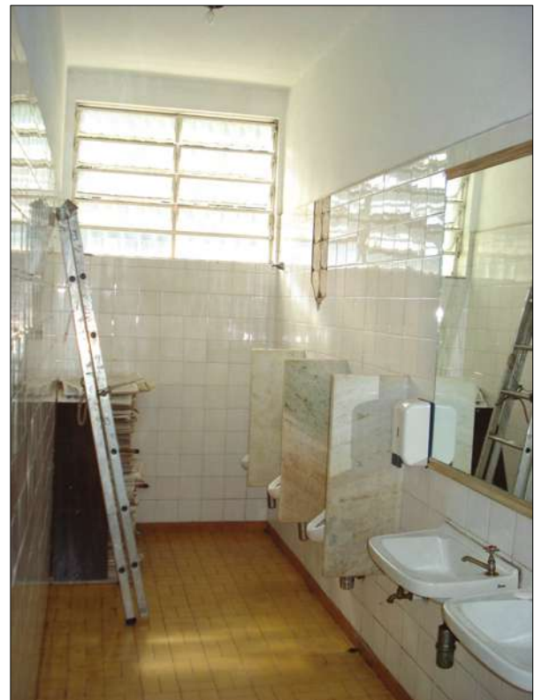
Fig. 5.15. – Pintura deteriorada dos caixilhos Fonte - Autor
