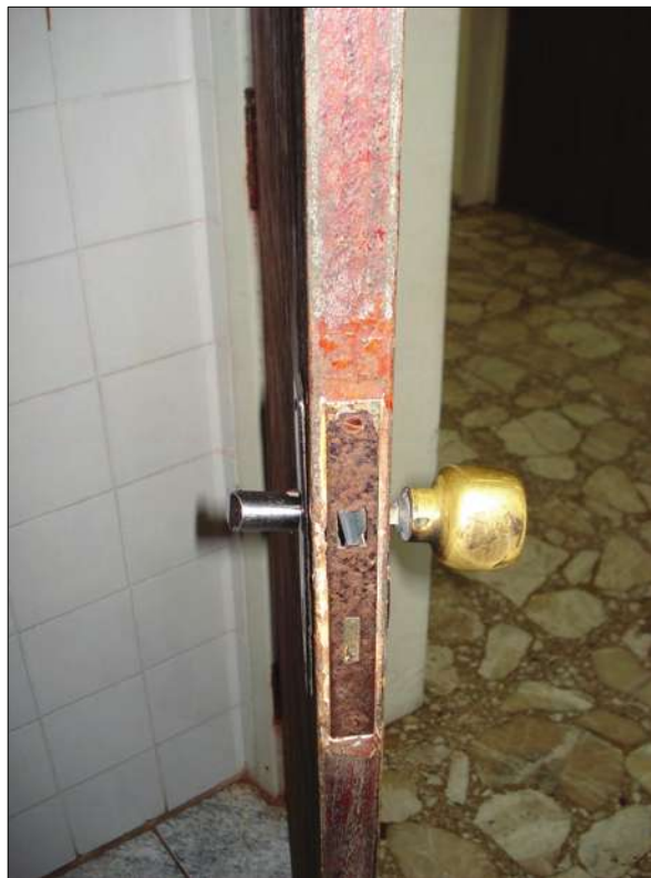
Fig. 8.22. – Fechadura da porta do banheiro deteriorada Fonte – Autor
