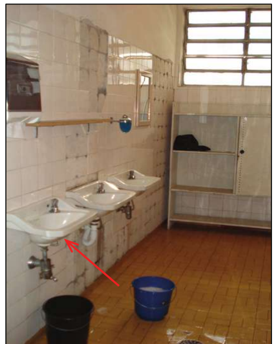
Fig. 4.47. – Substituição do sifão da pia sem qualquer critério estético Fonte – Autor
