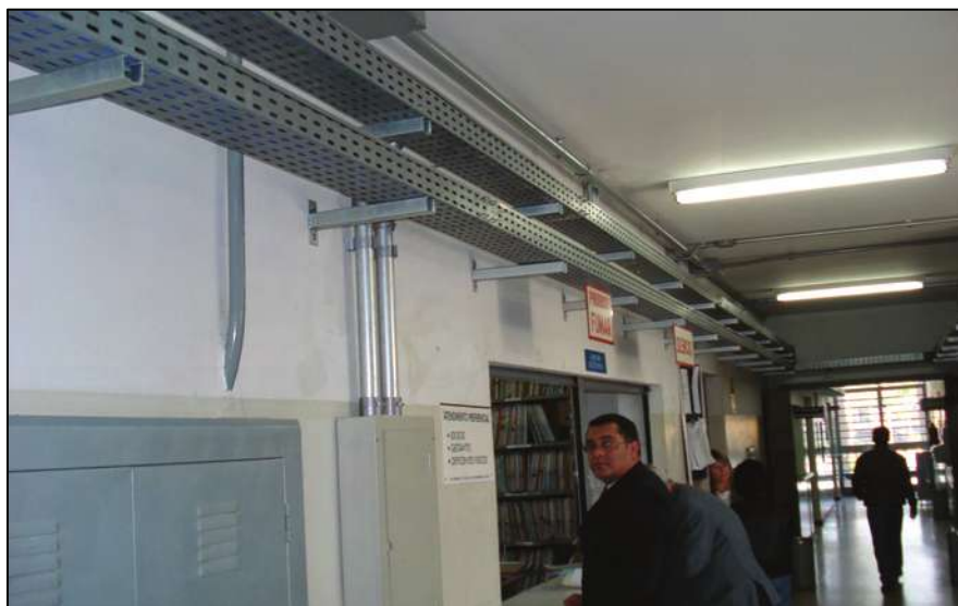
Fig. 4.37. – Instalações elétricas aparentes sem preocupação estética Fonte – Autor
