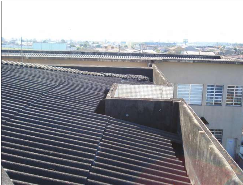
Fig. 8.14. – Degradação das telhas de fibrocimento Fonte – Autor
