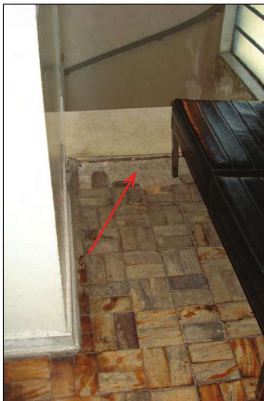
Fig. 4.33. – Tacos de madeira soltos e desgastados Fonte – Autor
