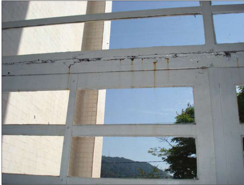
Fig. 5.13. – Detalhe da deterioração da pintura do caixilho Fonte - Autor
