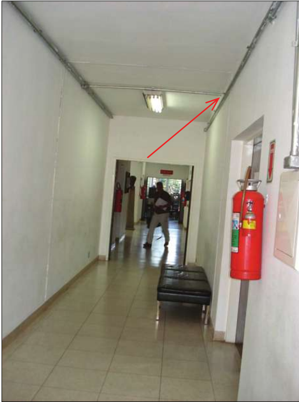
Fig. 5.26. – Instalações elétricas aparentes Fonte – Autor
