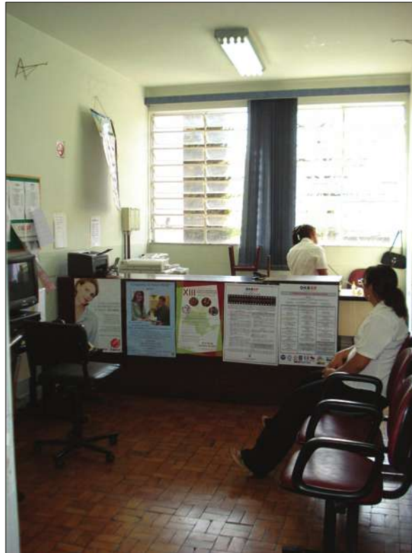
Fig. 5.25. – Tacos de madeira desgastados Fonte – Autor
