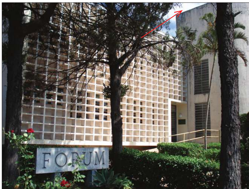
Fig. 9.16. – Degradação do p.v.a. (látex) da caixa de escada Fonte – Autor
