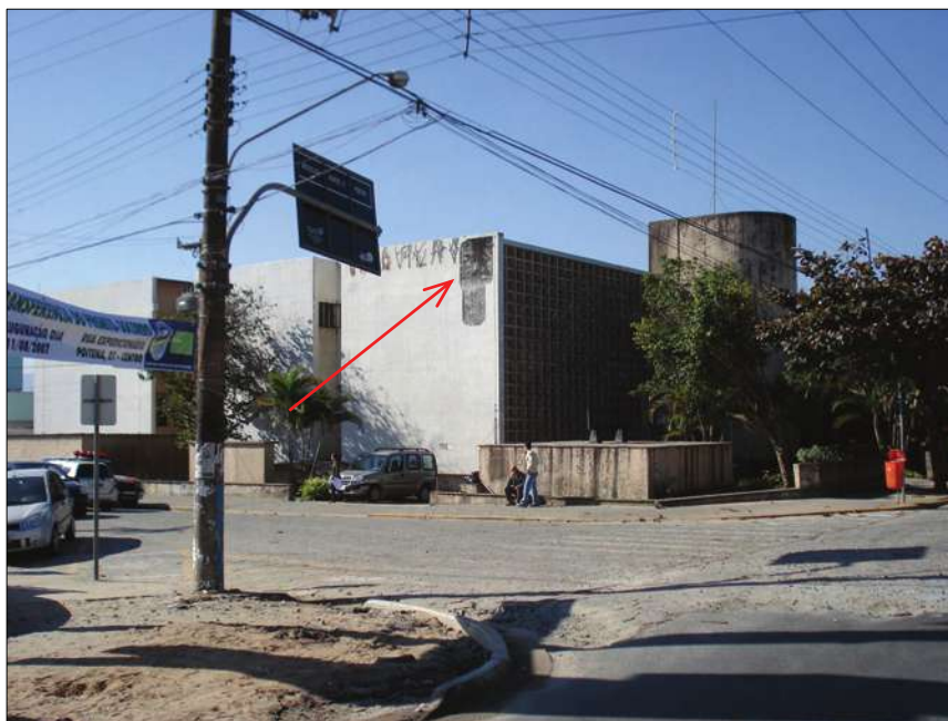
Fig. 8.24. – Destacamento das pastilhas das empenas laterais Fonte – Autor
