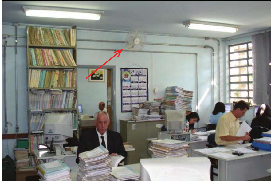
Fig. 4.39. – Ventilador instalado na parede Fonte – Autor
