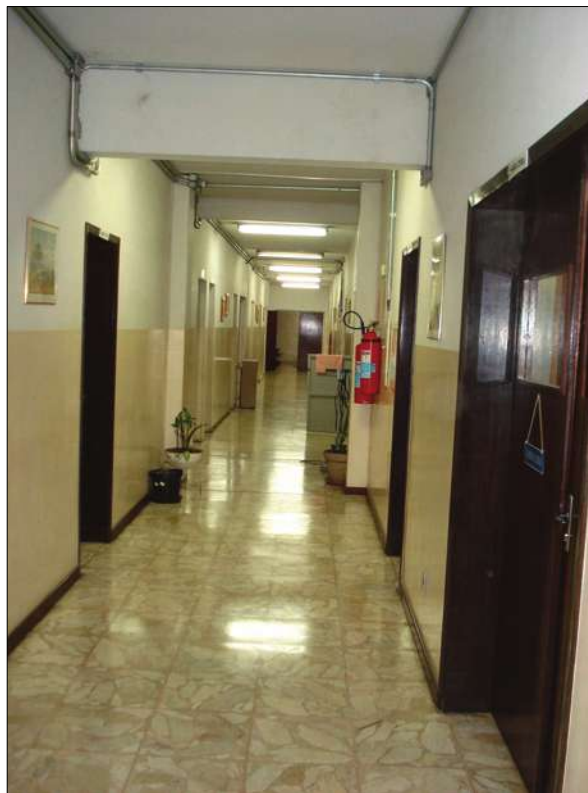
Fig. 6.31. – Instalações elétricas aparentes sem preocupação estética Fonte – Autor
