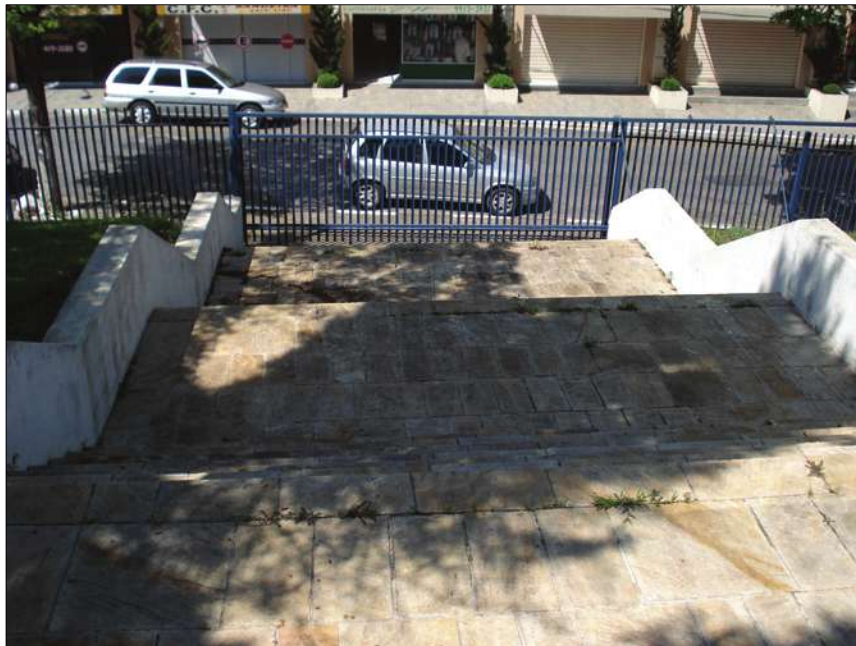
Fig. 5.22. – Detalhe da degradação das pedras de revestimento da escada. Fonte – Autor
