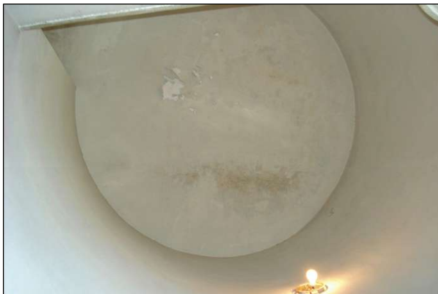
Fig. 4.10. – Infiltrações na laje da escadaria dos presidiários Fonte – Autor
