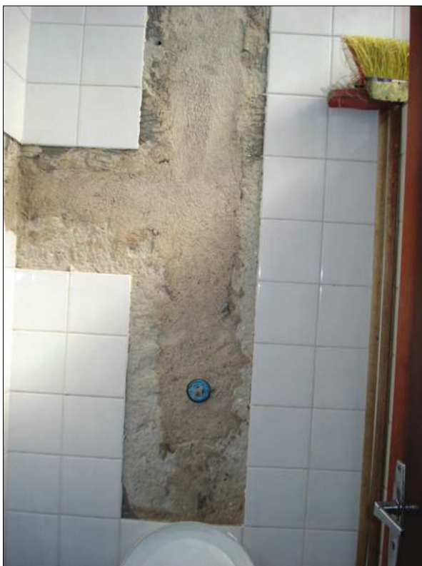
Fig. 8.26. – Azulejos soltos nos sanitários Fonte – Autor
