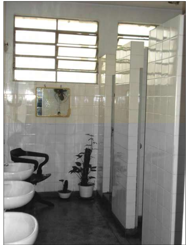
Fig. 6.21. – Pintura deteriorada dos caixilhos Fonte - Autor
