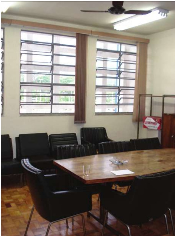
Fig. 6.18. – Caixilhos com pintura danificada Fonte – Autor
