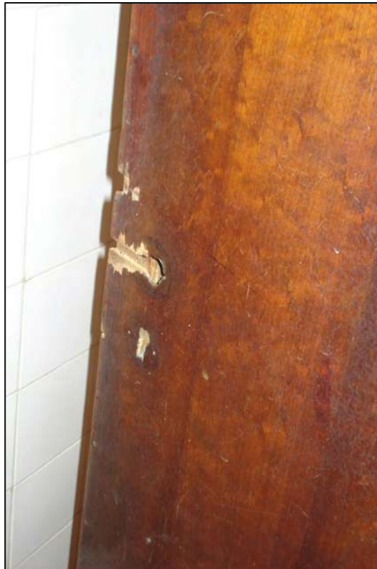
Fig. 4.20. – Porta do banheiro deteriorada (sem fechadura) Fonte – Autor
