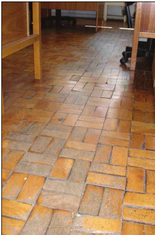
Fig. 4.34. – Tacos de madeira desgastados Fonte – Autor
