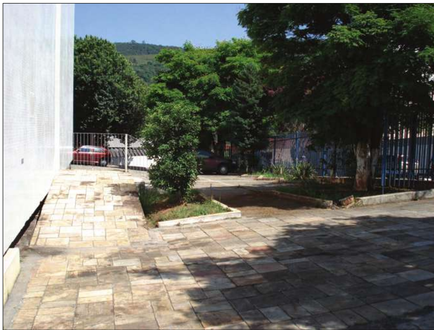
Fig. 5.21. – Degradação das pedras na lateral direita do edifício. Fonte – Autor
