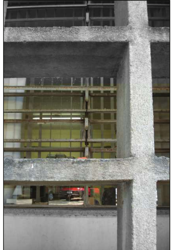
Fig. 4.26. – Degradação da pintura Fonte – Autor
