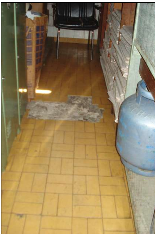
Fig. 4.35. – Cerâmicas soltas no depósito Fonte – Autor
