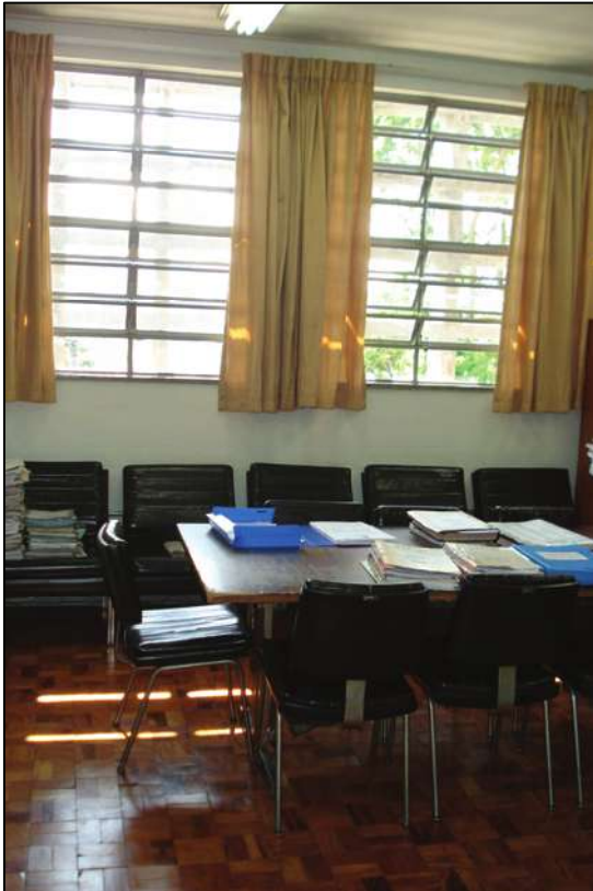
Fig. 4.16. – Caixilharia emperrada Fonte – Autor
