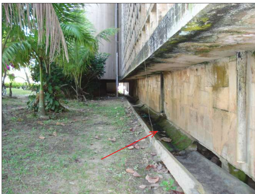
Fig. 8.34 – Canaletas de captação de águas pluviais degradadas Fonte – Autor
