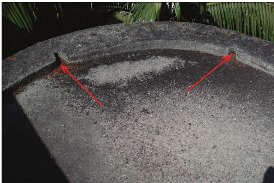
Fig. 4.7. - Vista externa da laje de cobertura da escadaria dos presidiários, notando-se que as saídas para o escoamento de águas de chuvas estão obstruídas por folhas.
