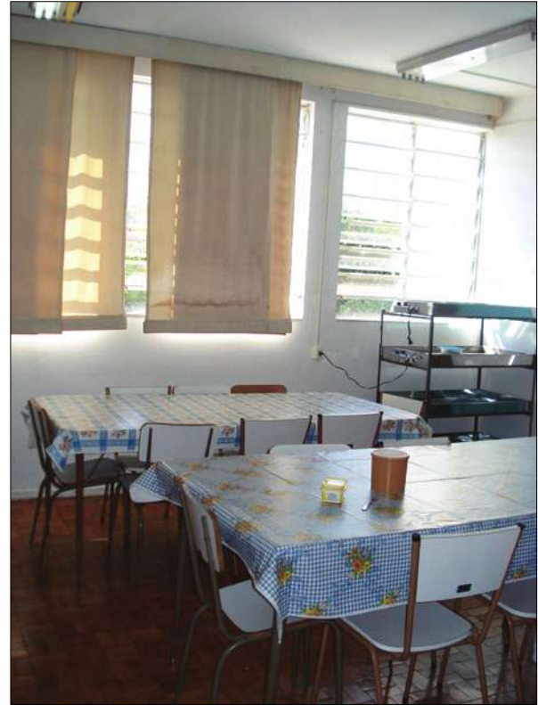
Fig. 5.24. – Degradação dos tacos de madeira Fonte – Autor
