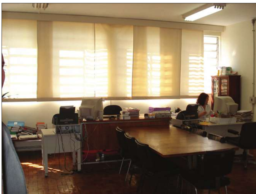
Fig. 5.17. – Excesso de luz e calor nos ambientes Fonte – Autor
