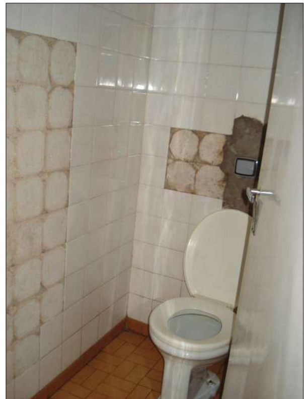
Fig. 5.20. – Azulejos soltos nos sanitários Fonte – Autor
