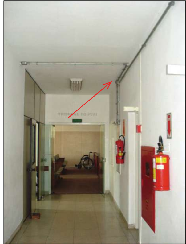
Fig. 5.27. – Tubulações elétricas aparentes Fonte – Autor
