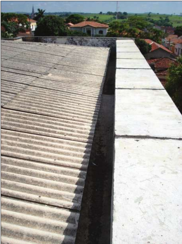
Fig. 9.9. - Vista da calha de captação de águas Fonte – Autor
