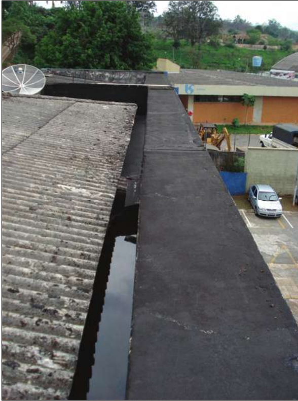
Fig. 6.11. - Vista da calha de captação de águas Fonte – Autor
