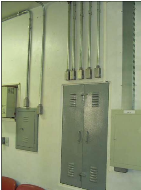
Fig. 7.20. – Instalações elétricas aparentes sem preocupação estética Fonte – Autor
