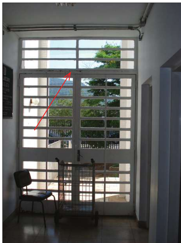
Fig. 5.12. – Caixilho com pintura danificada Fonte – Autor
