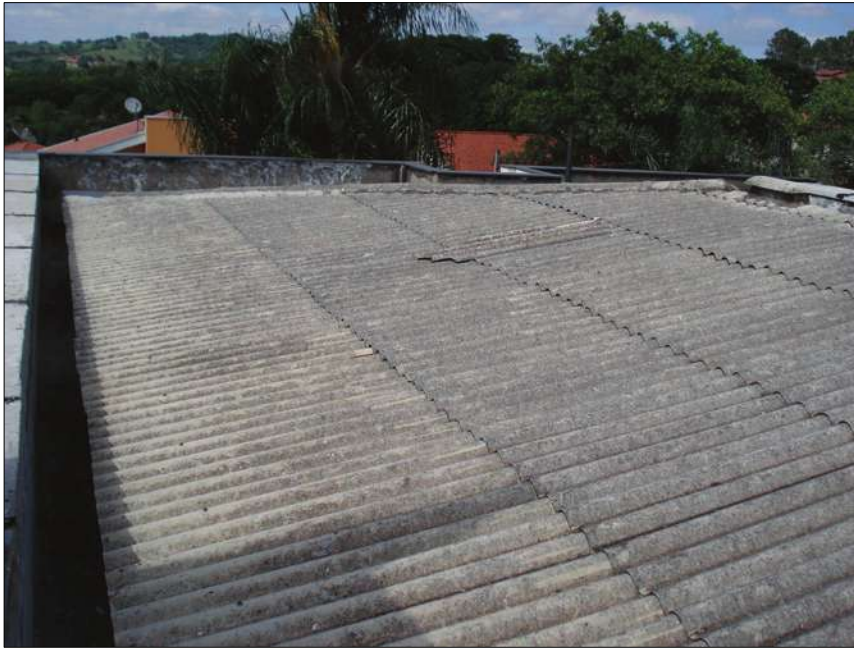
Fig. 9.11. – Degradação das telhas de fibrocimento Fonte – Autor
