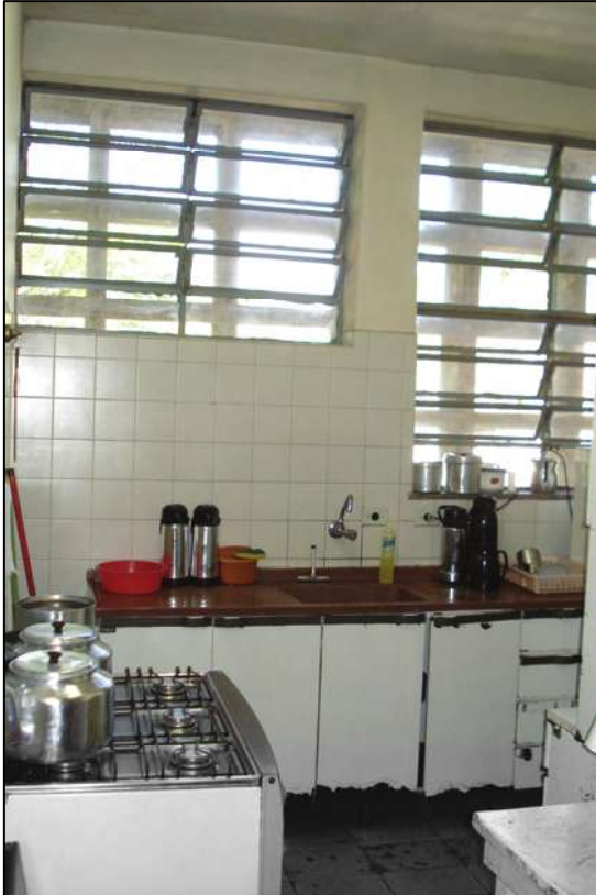
Fig. 4.25. – Degradação da pintura esmalte Fonte – Autor
