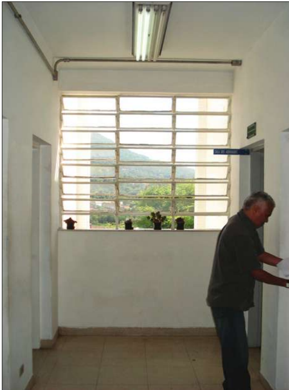
Fig. 5.14. – Caixilhos com pintura danificada Fonte – Autor
