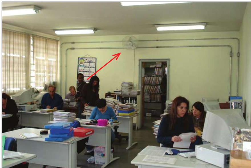
Fig. 4.38. – Ventilador instalado na parede Fonte – Autor
