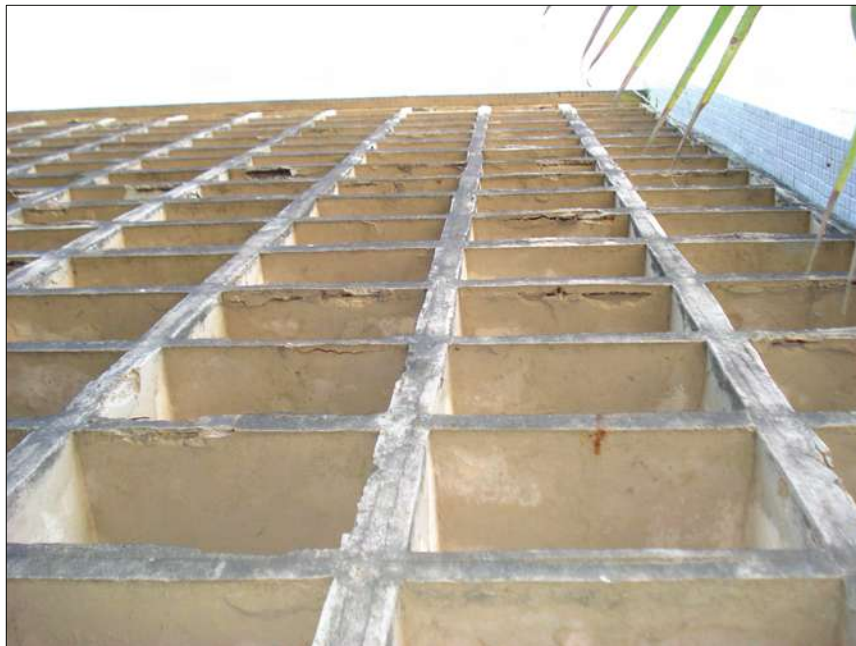
Fig. 8.17. – Degradação dos elementos da fachada principal sudoeste Fonte – Autor
