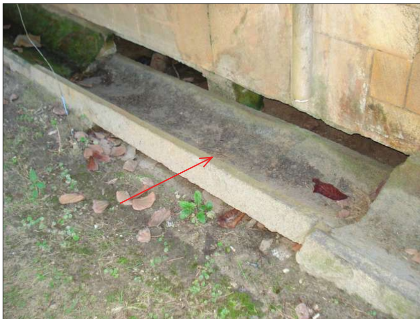
Fig. 8.35 – Canaleta de captação de águas pluviais desalinhada Fonte – Autor
