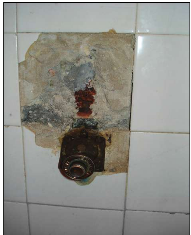
Fig. 4.41. - Detalhe da tubulação corroída Fonte – Autor
