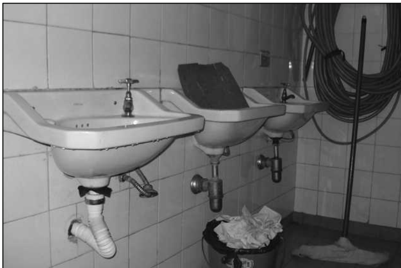
Fig. 4.49. – Sifão original substituído por outro de baixa qualidade Fonte – Autor
