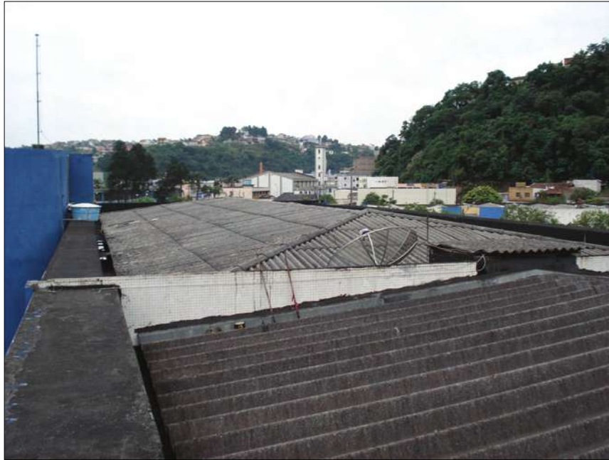
Fig. 6.13. – Degradação das telhas de fibrocimento Fonte – Autor
