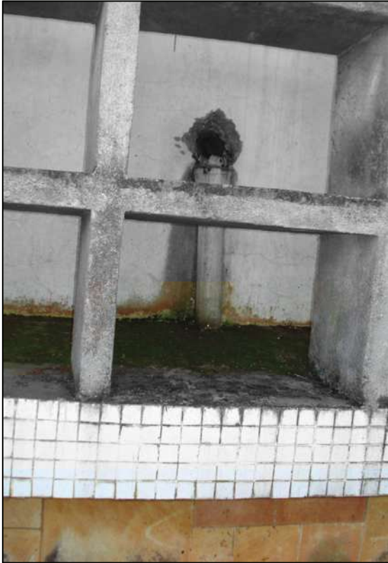
Fig. 4.42. - Tubulação ferro fundido Fonte – Autor
