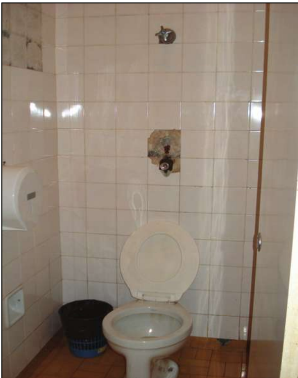
Fig. 4.40. - Tubulação de ferro galvanizado corroída junto a válvula de descarga Fonte – Autor
