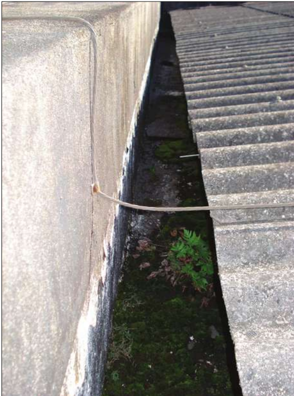
Fig. 8.12. - Vista da calha de captação de águas Fonte – Autor
