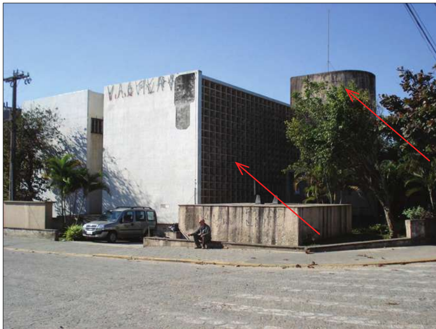
Fig. 8.23. – Degradação do p.v.a. (látex) da caixa de escada Fonte – Autor
