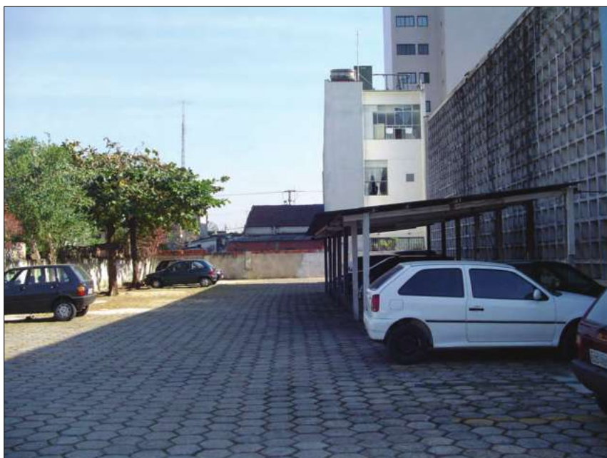
Fig. 7.8. – Piso do estacionamento com depressão generalizada Fonte – Autor
