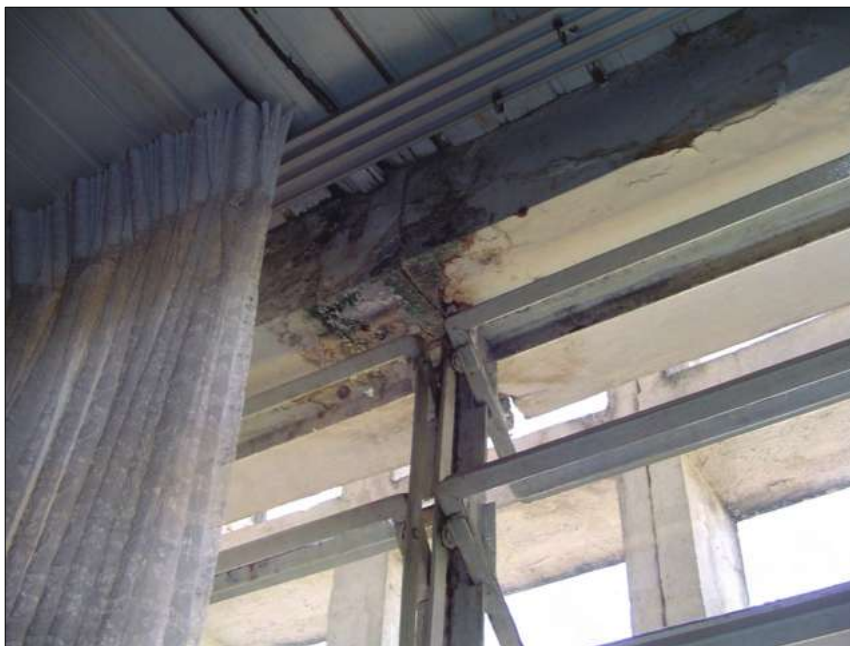
Fig. 7.10. – Infiltração na junta de dilatação no gabinete da 2ª Vara Judicial Fonte – Autor
