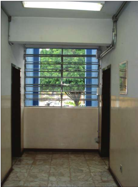
Fig. 6.20. – Caixilhos com pintura danificada Fonte – Autor
