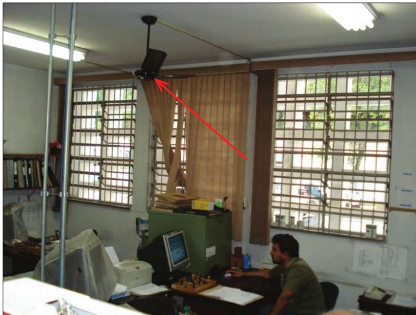
Fig. 6.32. – Ventiladores instalados no teto Fonte – Autor
