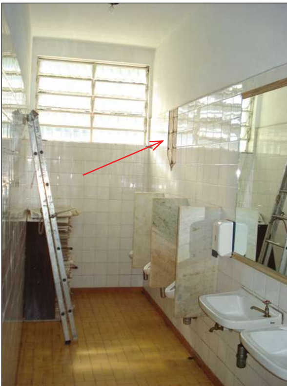
Fig. 5.19. – Azulejos soltos no sanitário Fonte – Autor
