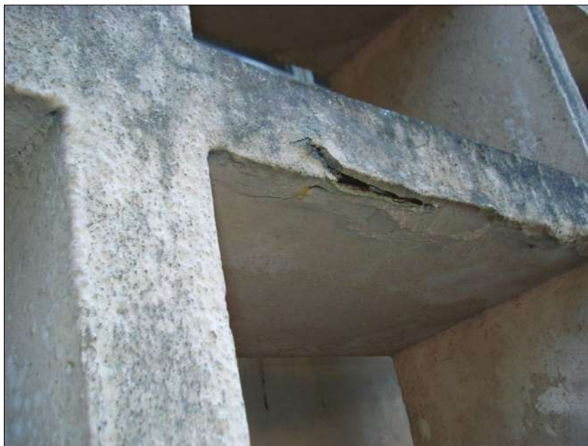
Fig. 8.18. – Oxidação da ferragem dos elementos vazados Fonte – Autor
