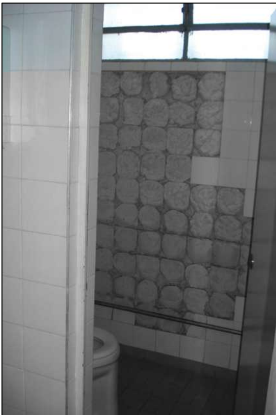
Fig. 4.27. – Azulejos soltos no sanitário Fonte – Autor
