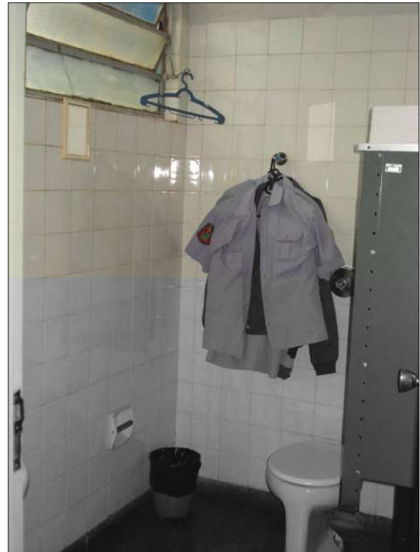
Fig. 6.19. – Pintura deteriorada dos caixilhos Fonte - Autor
