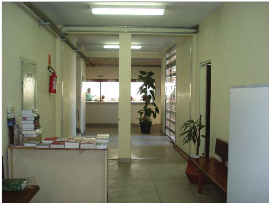
Fig. 8.32. – Instalações elétricas aparentes sem preocupação estética Fonte – Autor
