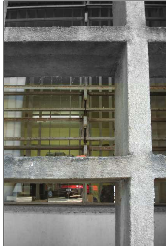
Fig. 4.17. – Caixilhos oxidados Fonte – Autor
