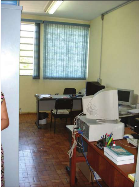
Fig. 5.23. – Tacos de madeira desgastados Fonte – Autor
