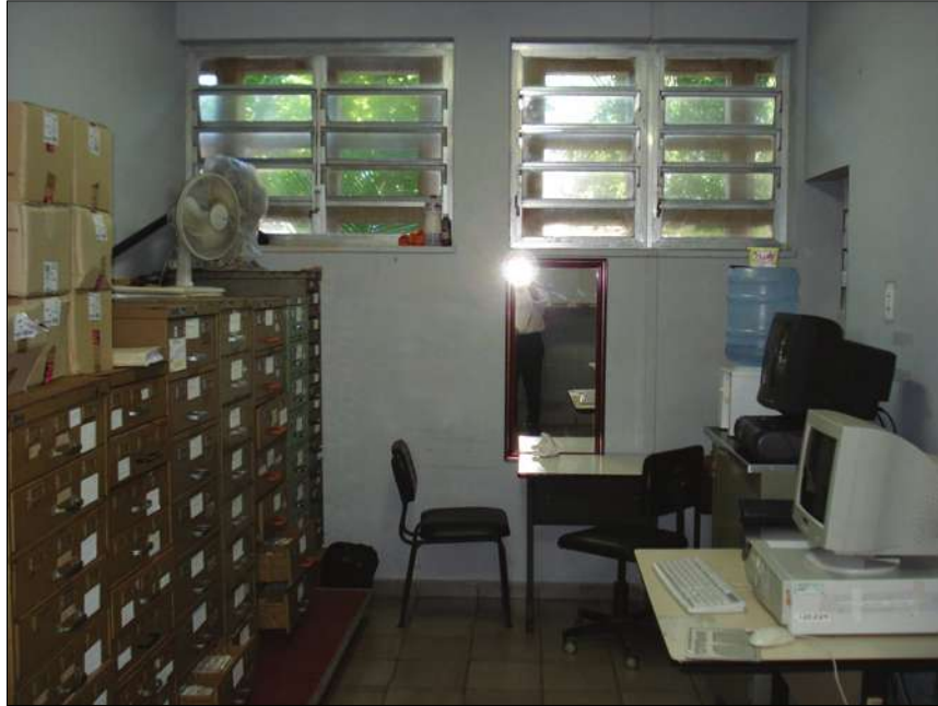
Fig. 8.19. – Degradação dos caixilhos Fonte – Autor
