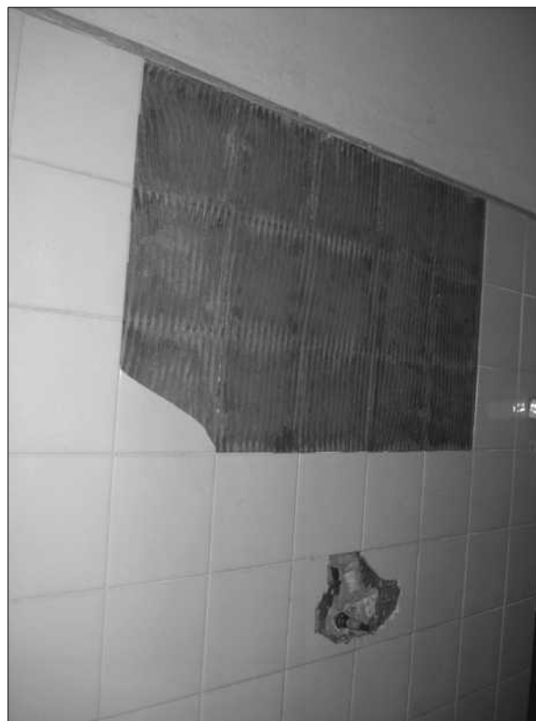
Fig. 8.27. – Azulejos soltos nos sanitários Fonte - Autor
