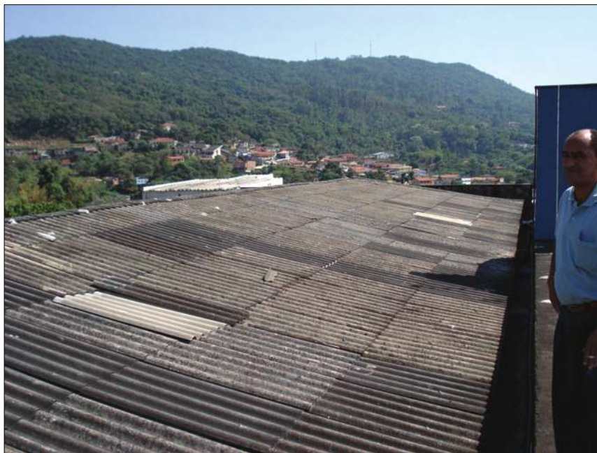
Fig. 5.9. – Degradação das telhas de fibrocimento Fonte – Autor
