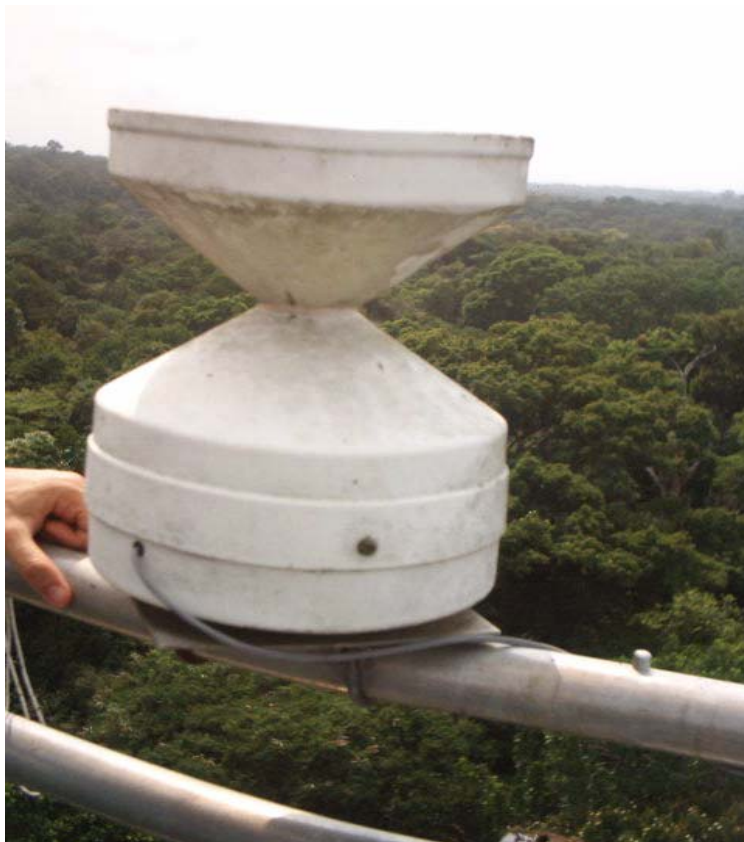
Figura 9. Pluviógrafo instalado no topo da torre micrometeorológica
