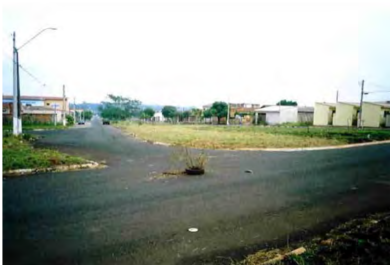
Figura 33. Rede de esgoto sem tampa em meio a uma avenida entre os bairros Jd. Florestan Fernandes e Jd. Diva Tarlá de Carvalho (18 de jul. 2005).
