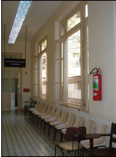
FIGURA 23: Foto da área de espera-quimioterapia, Hospital Borges da Costa Fonte: Trabalho de campo, 2009.
