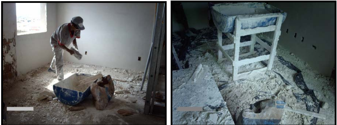
Figuras 34a e 34b – Resíduos de gesso no pavimento
