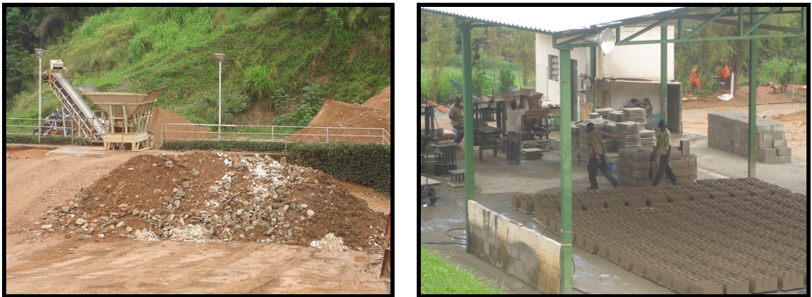
Figuras 2a e 2b - Usina de Reciclagem Estoril – Belo Horizonte/MG.
