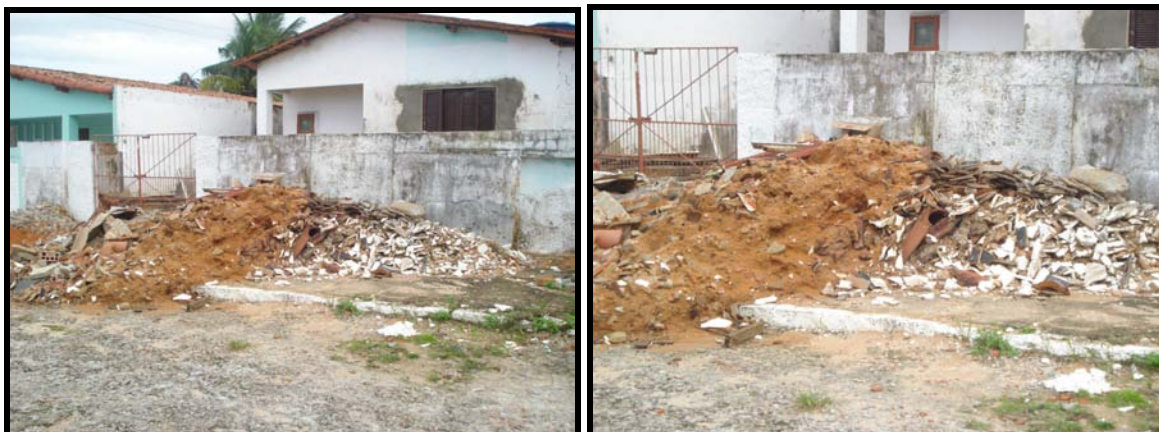
Figuras 36a e 36b – Reformas residenciais e disposição ilegal dos resíduos
