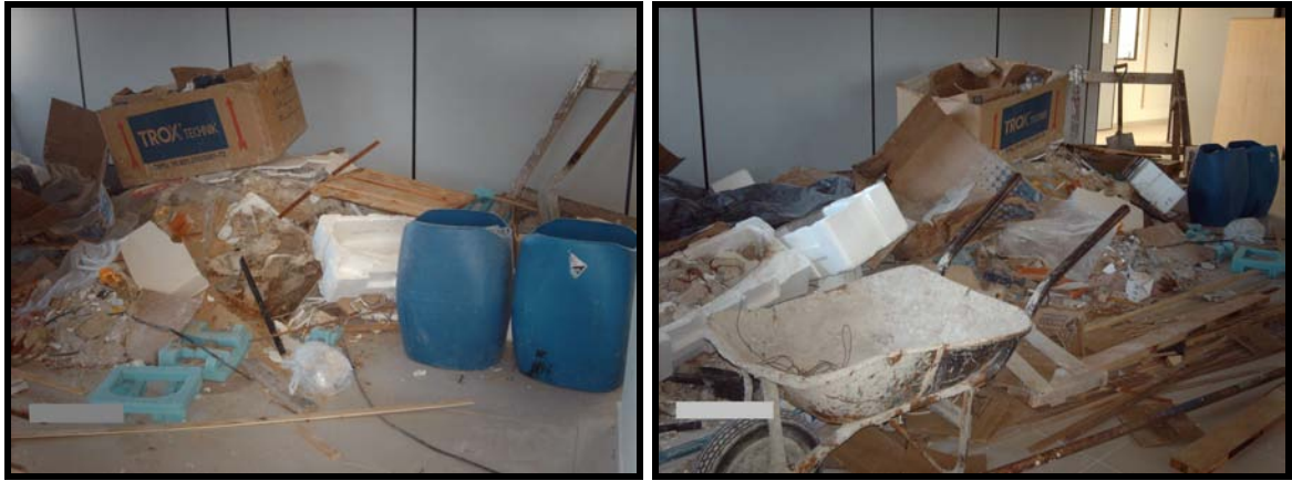
Figuras 33a e 33b – Desorganização no pavimento
