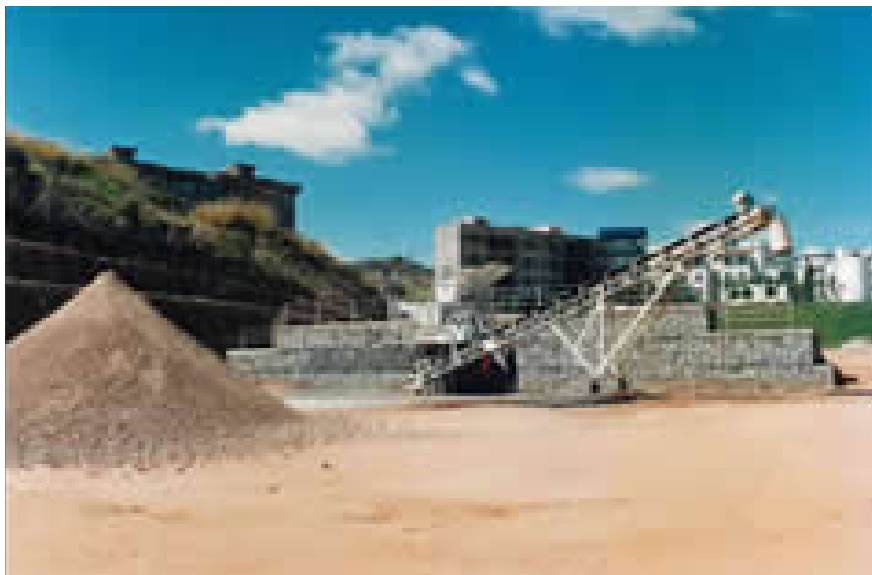
Figura 4.4: Usina de Reciclagem de RCD – Estoril – Belo Horizonte (MG). Fonte: www.maqbrit.com.br (2009).
