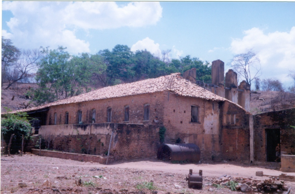
Foto 27 – Ruínas do Tupinambá em 2001. A parte que corresponde à Casa Grande resistindo temporariamente ao desabamento do engenho, na mesma estrutura. (É interessante fazer uma comparação com a Foto 17) Fotografia: Yacê Carleial.
