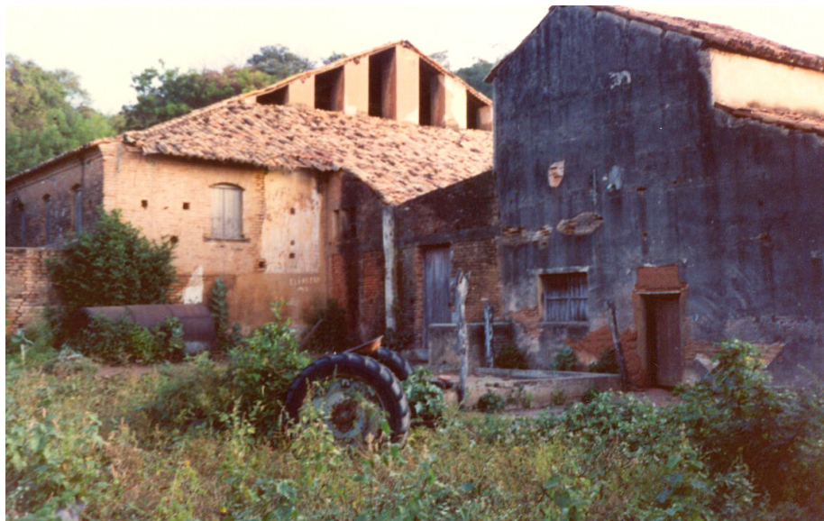
Foto 15 – Face norte do Tupinambá , no início dos anos 1990, pouco tempo antes do desabamento do telhado. Observa-se, vistas de fora, as aberturas entre pilares, criadas a partir dos desníveis das águas da cobertura. Fotografia Yacé Carleial.
