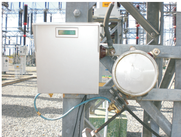
Figura 5.17 – Fotografia do sistema de medição de medição instalado.
