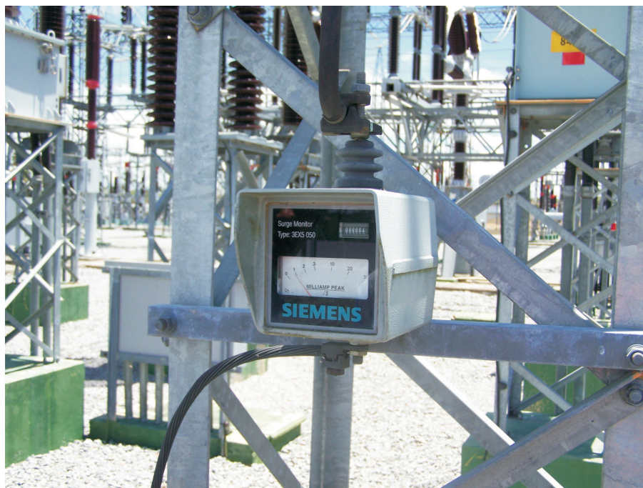
Figura 3.1 – Miliamperímetro instalado permanentemente em para-raios de ZnO.
