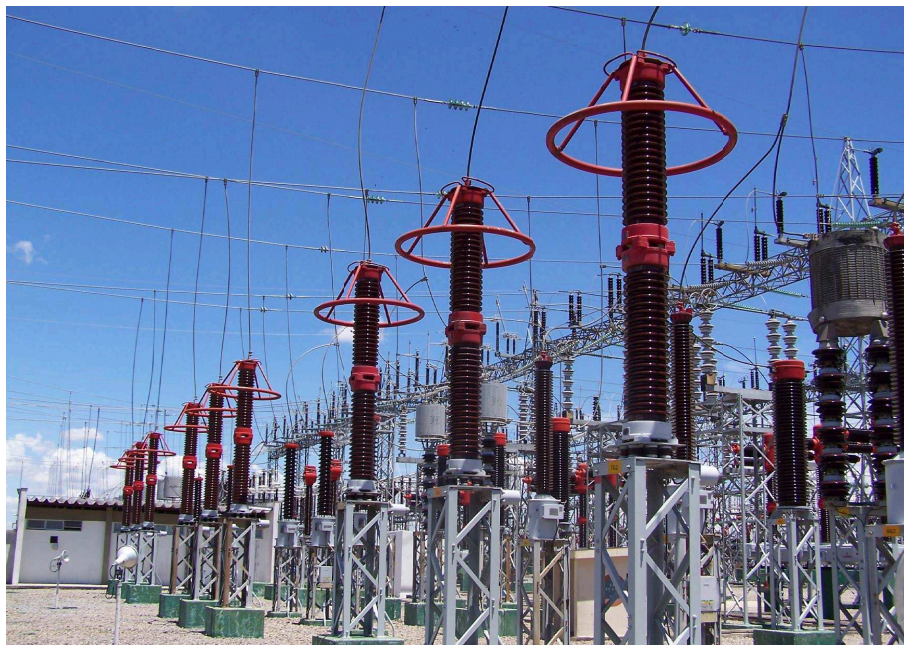
Figura 2.1 – Foto da localização de um para-raios em uma subestação de 230kV - CGII-CHESF.
