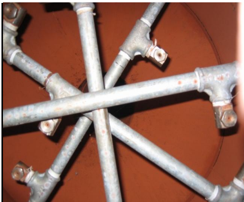
Figura 3.10 – Vista inferior do sistema de aspersão
