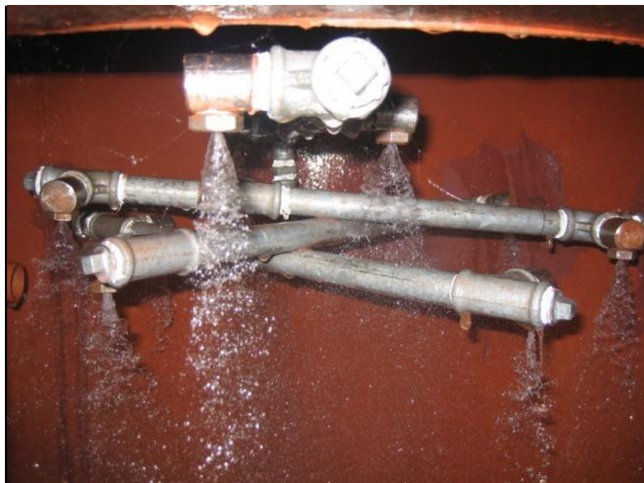
Figura 3.11 – Sistema de aspersão com bicos de aço inoxidável operando com água
