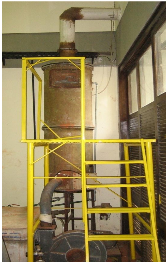
Figura 3.3 – Lavador de gases ou reator (vista frontal)
