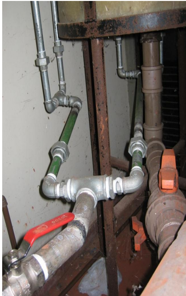
Figura 3.9 – Tubulação de recalque em aço galvanizado.
