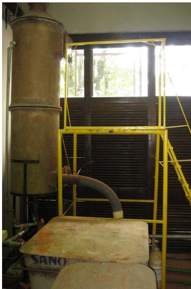
Figura 3.4 - Lavador de gases ou reator (vista lateral)
