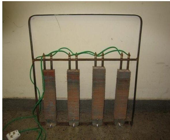
Figura 3.16 - Sistema de aquecimento elétrico
