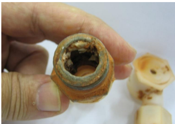
Figura 4.16 – Deposição de material na tubulação.
