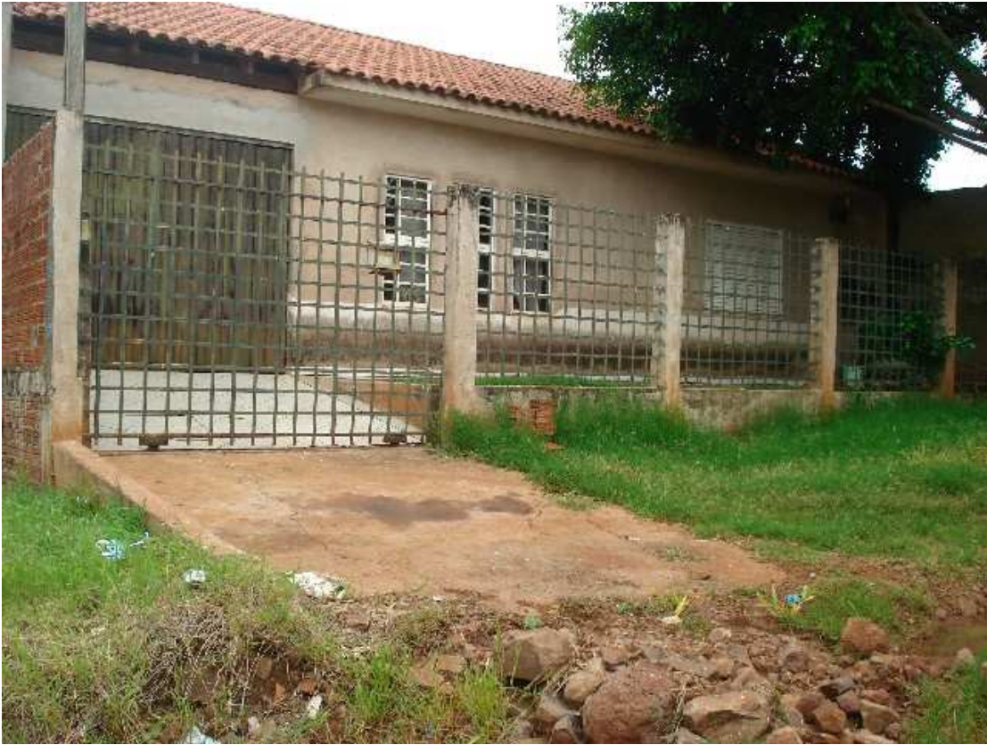
Fotografia 2 – Residência com umidade no Tarumã II devido a afloramento do lençol freático. Fonte: A autora (Jan. 2009).
