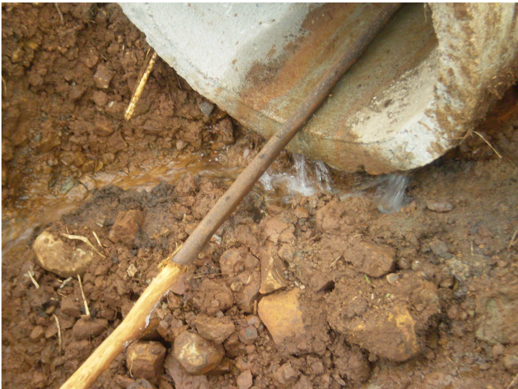
Fotografia 8 - Surgência do lençol freático no Tarumã II - 3. Fonte: Matievecz (Dez. 2005).
