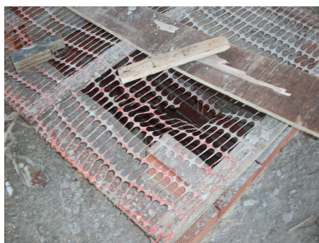
Foto 4 - Tela danificada tapando abertura no piso. Fonte: BATISTA, José Roberto, Trabalho de Campo, 2009 – 2010.
