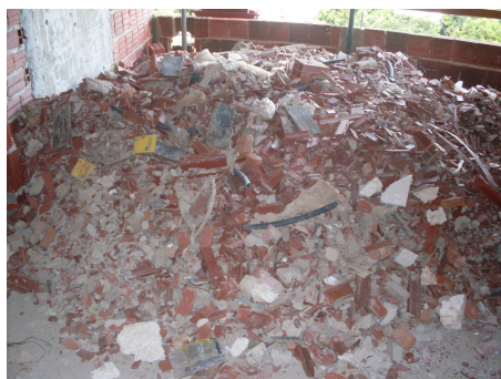
Foto 6 - Restos de materiais de construção. Fonte: BATISTA, José Roberto, Trabalho de Campo, 2009 – 2010.
