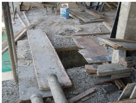
Foto 1 - Ferramentas, restos de materiais e abertura no piso. Fonte: BATISTA, José Roberto, Trabalho de Campo, 2009-2010.
