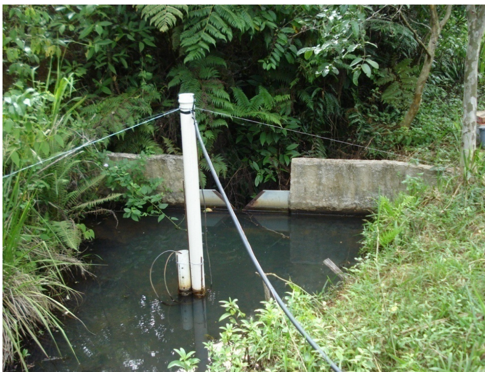
Figura 11 – Vista parcial do vertedor construído no exutório da microbacia do Córrego Jaqueira, Alegre-ES.
