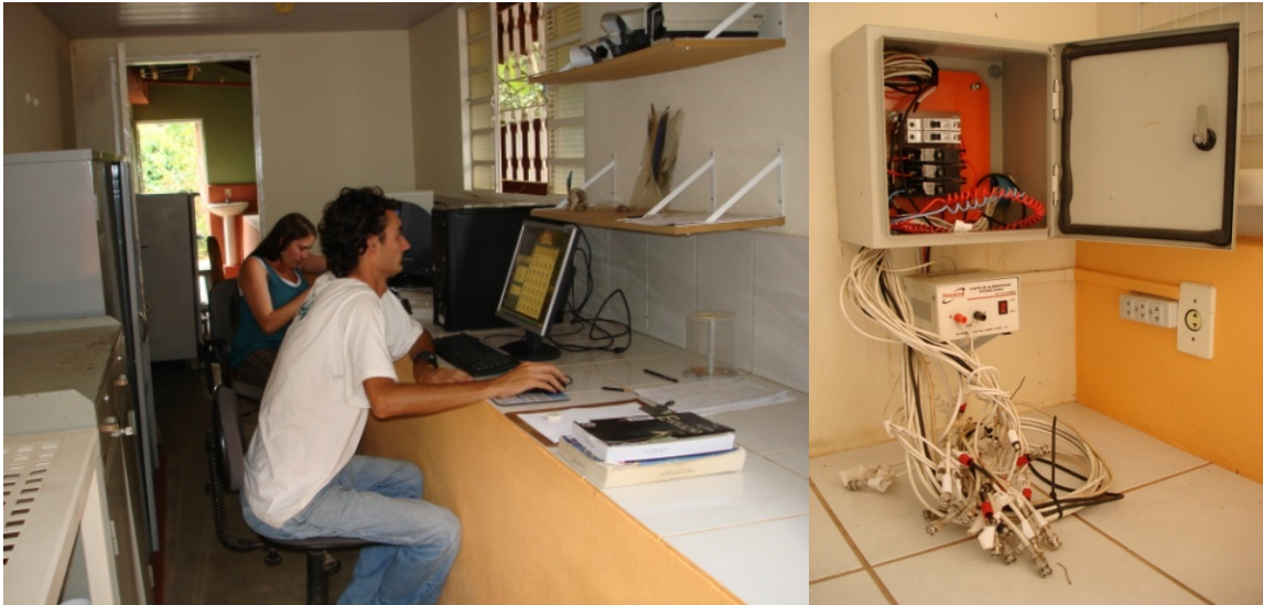
FIG 16 – Central de recepção das imagens devidamente equipado e detalhe da recepção dos cabos das câmeras no local
