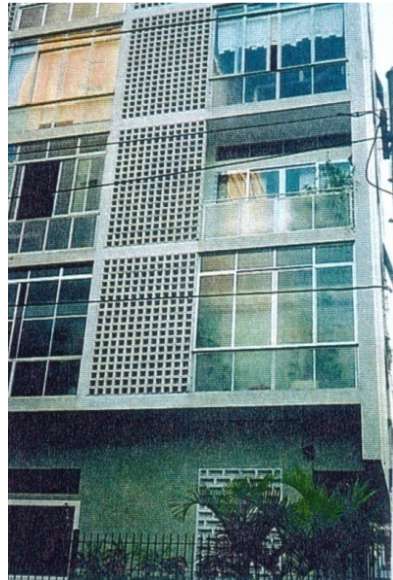
FIGURA 41- Edifício Ouro Verde, SP, 1952. Arquiteto Franz Heep – Detalhe de empena cega e elemento vazado. Fonte: Barbosa, 2002.
