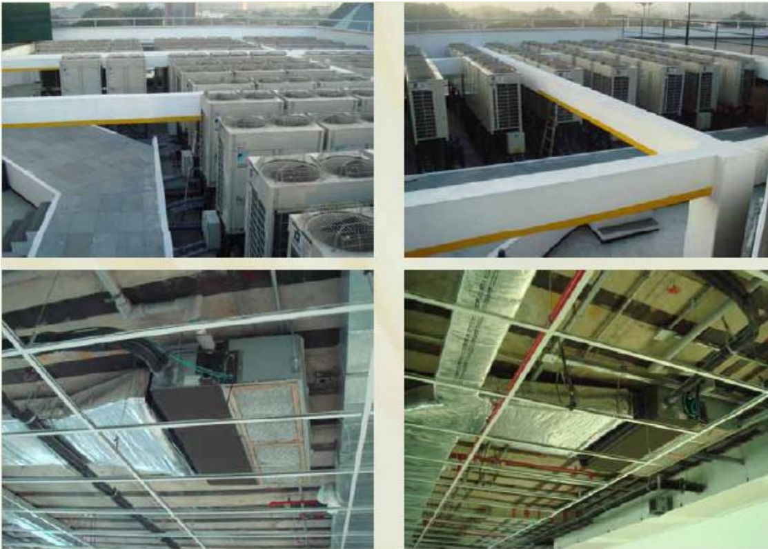
FIGURA 70 – Condicionamento de ar. Fonte: Gafisa, 2009.
