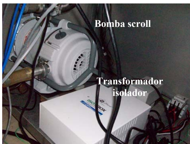
FIG.3.4 Fotografia da parte interna do rack, onde se pode ver a bomba do tipo scroll e o transformador isolador.
