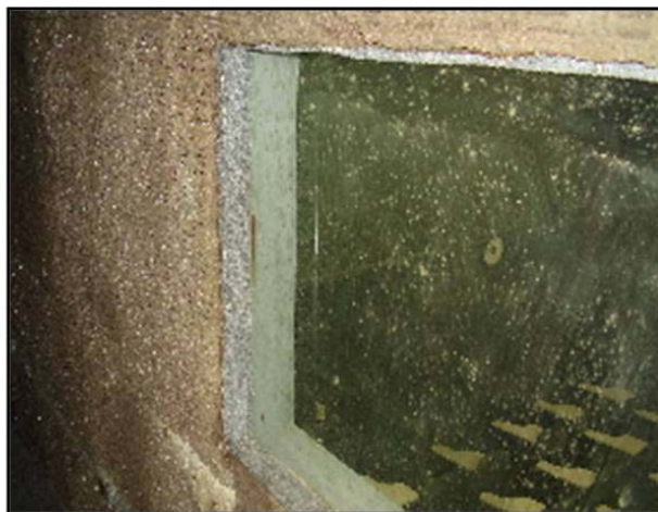
Figura 7- Janelas sem proteção
