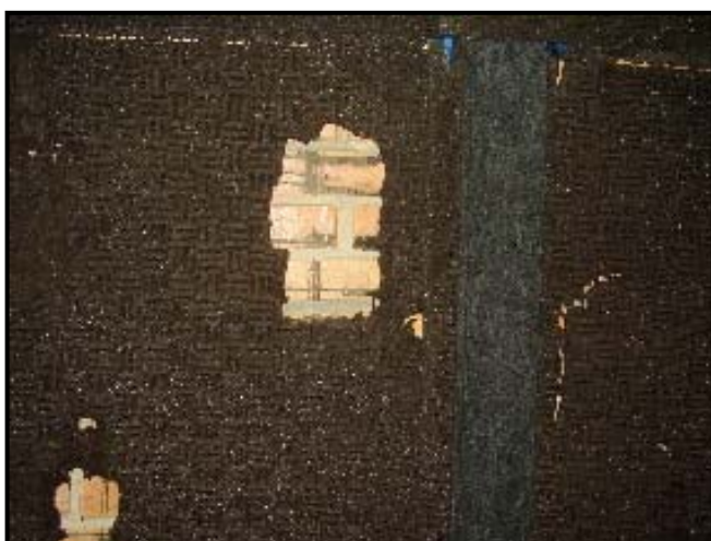
Figura 18- Revestimento de espuma desprendendo da parede
