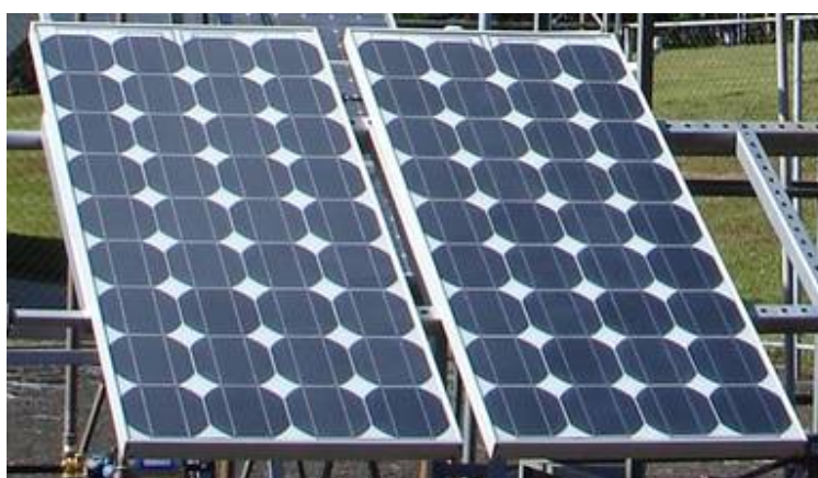
Figura 38 – Painéis solares fotovoltaicos monocristalinos.
