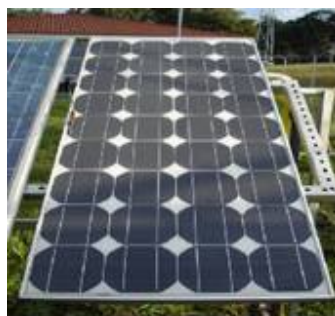
Figura 5 – Painel solar fotovoltaico (Laboratório NEAR/FCA/UNESP).
