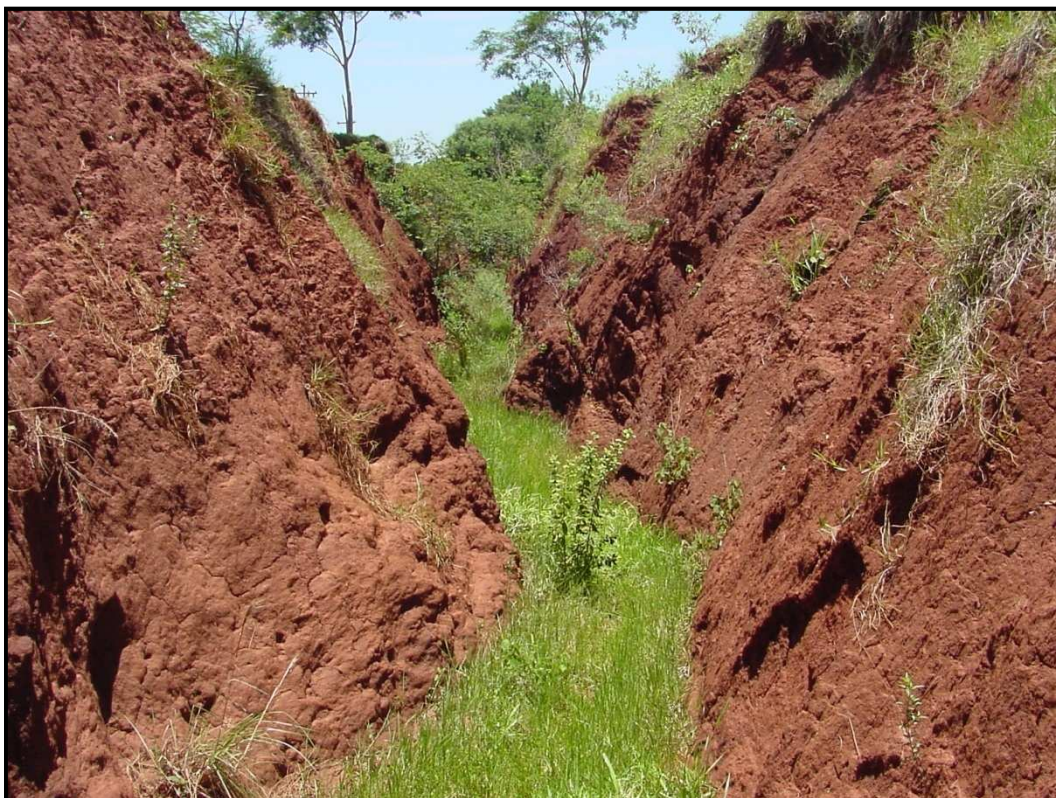
FIGURA 22 – Vista interior de voçoroca com cerca de 6 m de profundidade, no município de Glória de Dourados- MS. Fonte: Nunes (2004).
