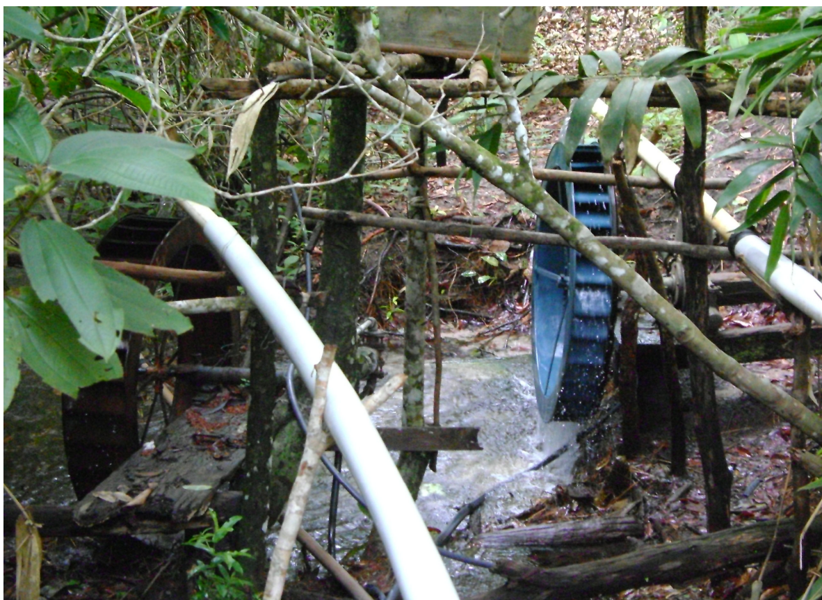
Figura 38 – Sistema de captação e distribuição de água instalado no assentamento, através da roda d'água.
