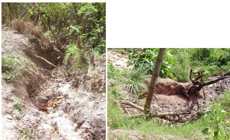
Fotos 23 e 24 – Feições Erosivas encontradas nas margens das ruas sem pavimentação do bairro do Alam Grei.
