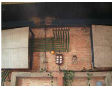
FIGURA 169 – Tubulação da cascata do Teatro Oficina. Fonte: Foto do autor, 2009
