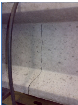
Figura 7-34 – Marcação da 1ª fissura
