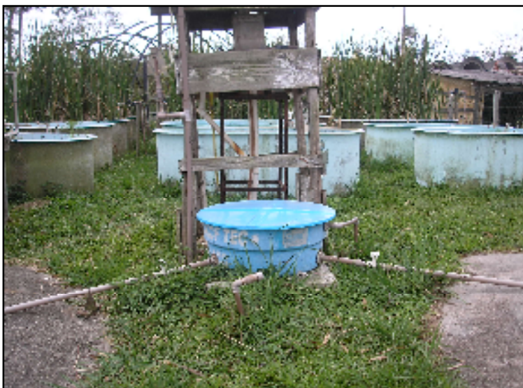
Figura 14: Tanque de distribuição do efluente da lagoa facultativa da ETE Potecas.
