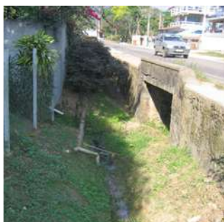
Figura 4. 8. Canal de drenagem com ligação com o rio sob via, despejo de esgoto
