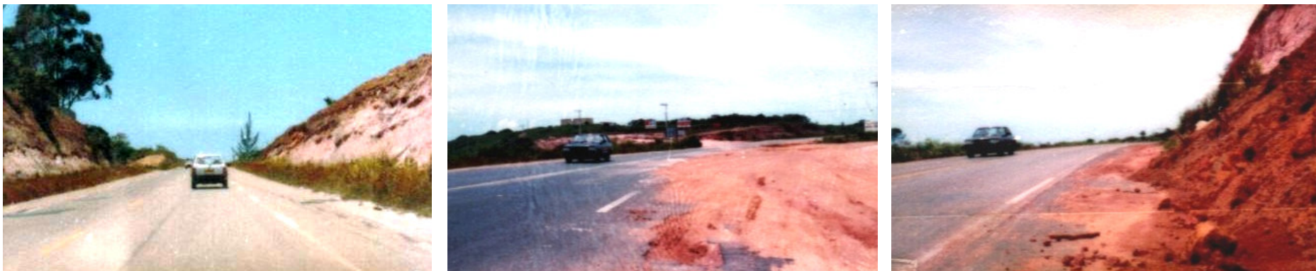
Figura 21: Trechos da Rodovia ES 060 que apresentavam avançada erosão em 1989, entre Ponta da Fruta e Barra do Jucu.
