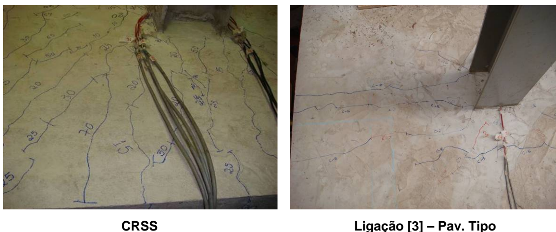
Figura 7.12: Fissuração na laje ao término do ensaio para o protótipo isolado CRSS e na Ligação [3] do pavimento tipo.
