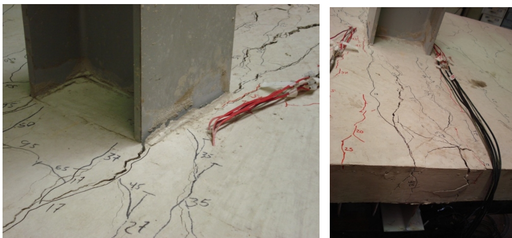
Figura 5.17: Fissuração da laje ao término do ensaio do protótipo CNRSS.
