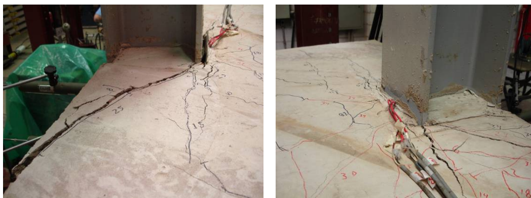
Figura 5.5: Fissuração da laje ao término do ensaio.
