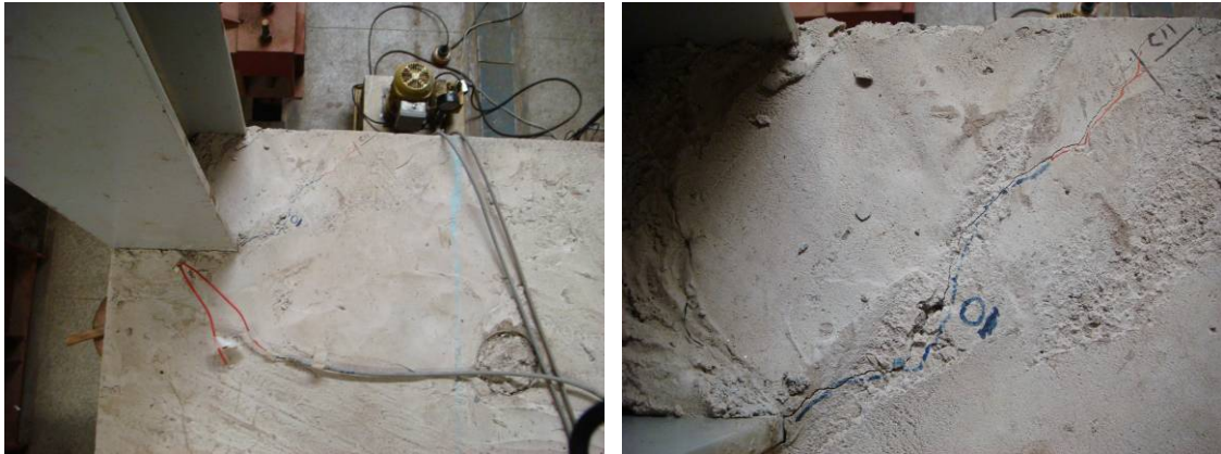
Figura 5.36: Fissuração da laje de concreto na Lig [2] após o ensaio.
