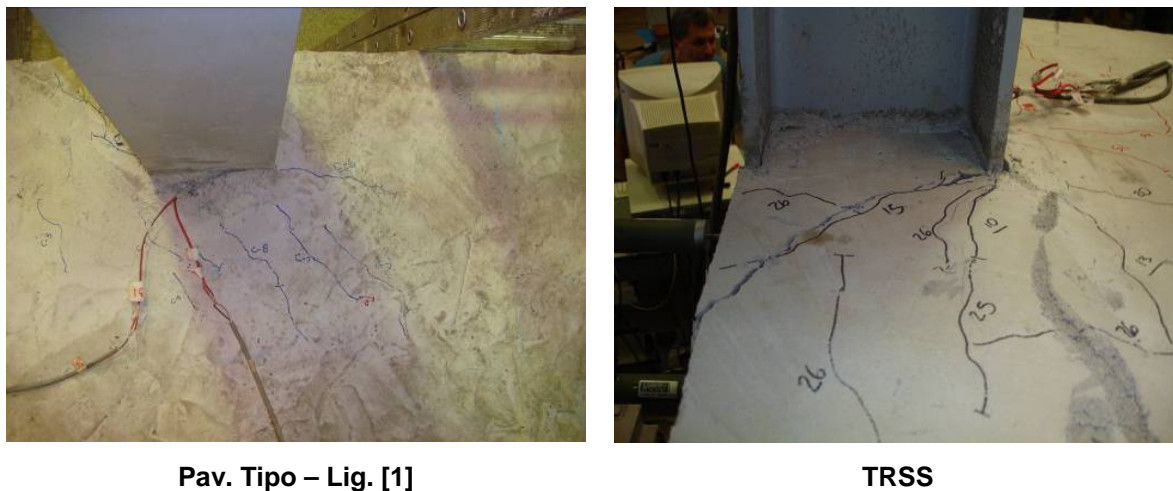
Figura 7.18: Fissuração da laje na Ligação [1] do pavimento tipo após a etapa de carregamento concentrado e da laje no modelo isolado TRSS.
