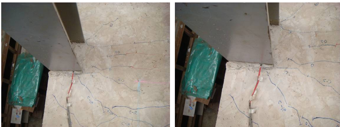
Figura 5.46: Fissuração da laje de concreto na ligação [4] após o ensaio.
