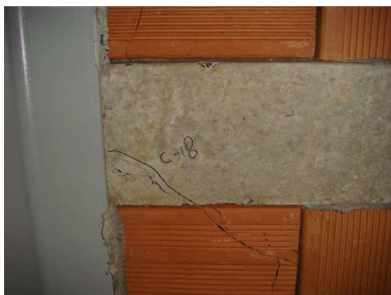
Fissuração da vigota e lajota
