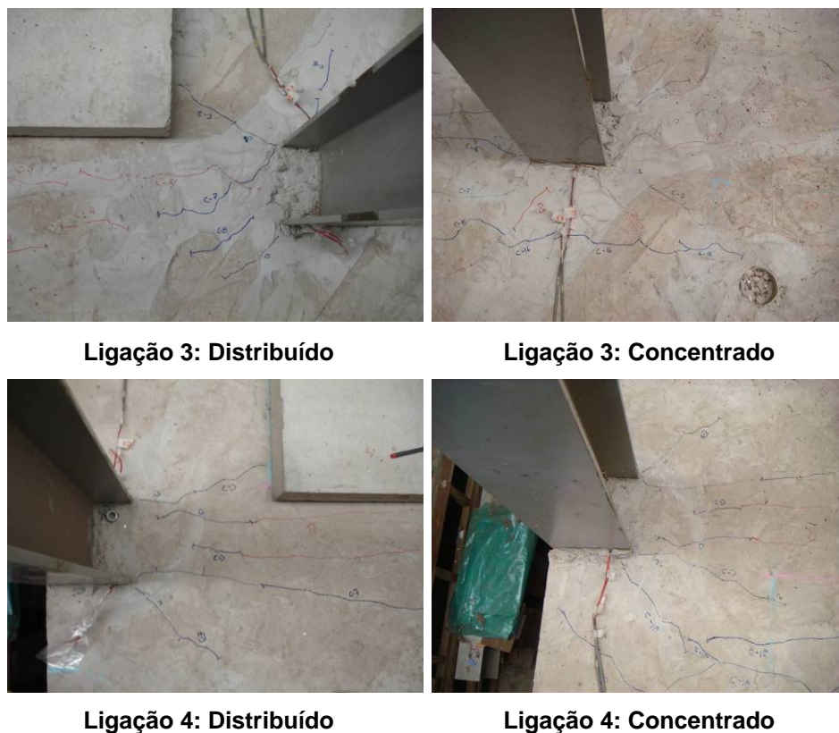
Figura 7.24: Fissuração da laje nas ligações do pavimento tipo ao término das etapas de carregamento distribuído e concentrado.
