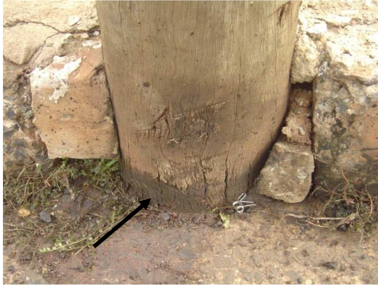
FIGURA 4.19 – Poste de madeira instalado inadequadamente
