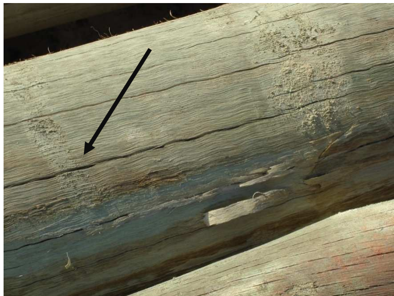
FIGURA 4.3 – Fendas na superfície postes de eucalipto
