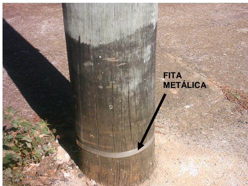
FIGURA 4.15 – Poste com pintura impermeabilizante e fita metálica no afloramento
