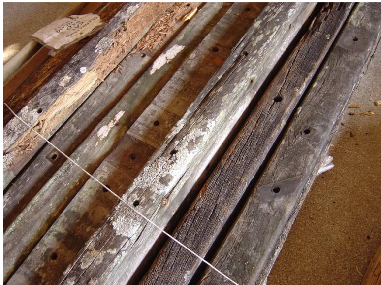
FIGURA 4.2 – Cruzetas deterioradas por fungos
