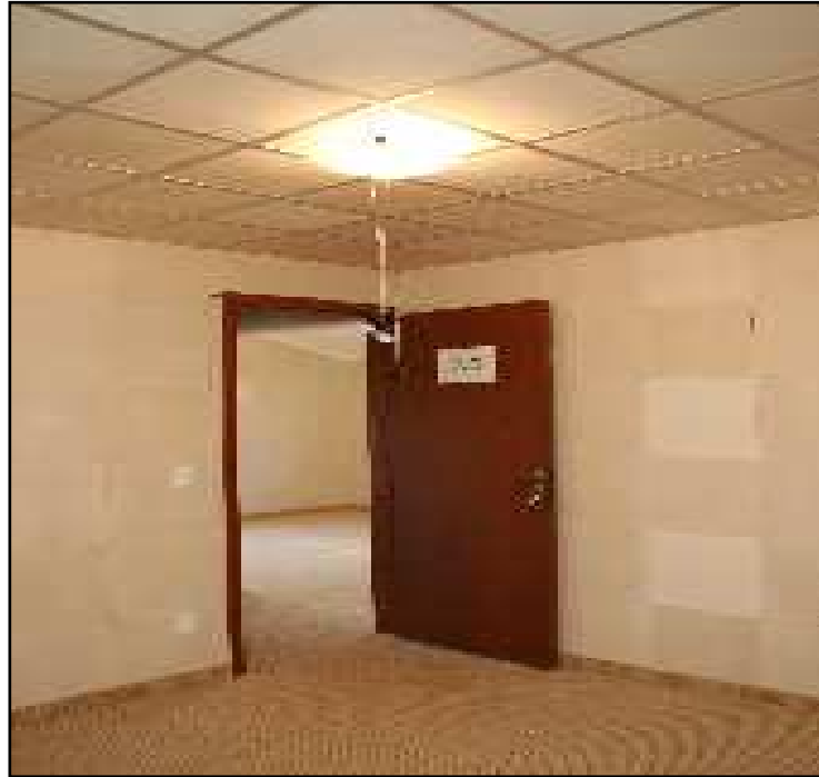
Figura 17. Detalhe das paredes sem acabamento do quarto 2. (Fonte: Imagem cedida pela Inovamat)
