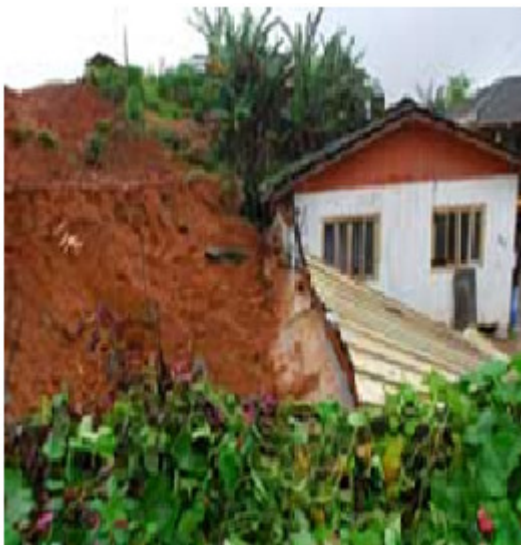
Figura 5 – Escorregamentos em Joinville 2008
