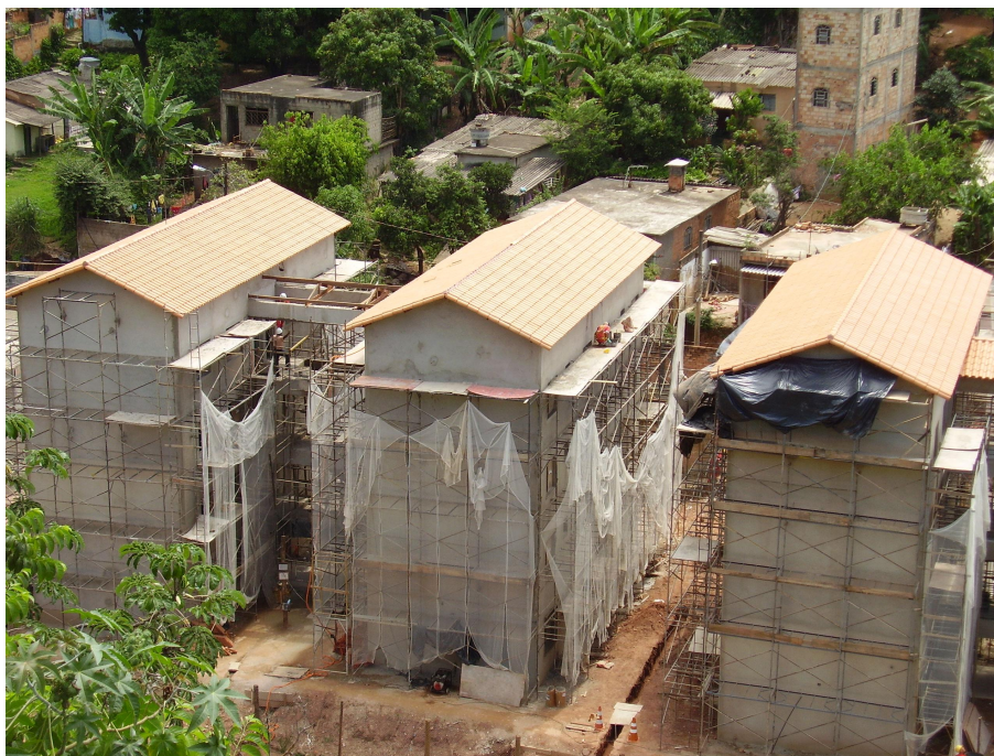
Foto 10: Detalhe do condomínio Santa Terezinha, conjunto que irá conter 112 unidades habitacionais ao final de sua construção. Autor: Luiz Antônio E. de Andrade. Data: 05/12/09.
