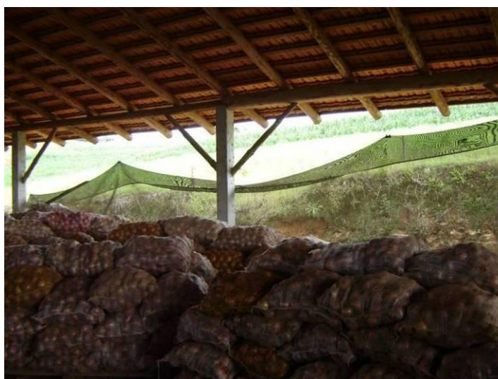
Figura 21: Galpão atingido pelo temporal
