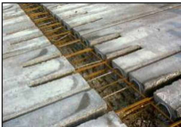
Figura 1.13: Armadura de continuidade do momento negativo localizada nas aberturas feitas na parte superior das unidades alveolares (fonte: Ferreira, 2007).
