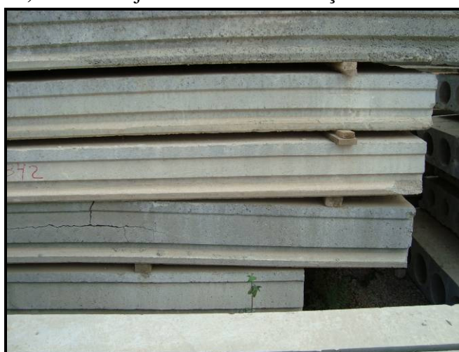
b) Lajes com fissuras devida a estoque com calços desalinhados.
