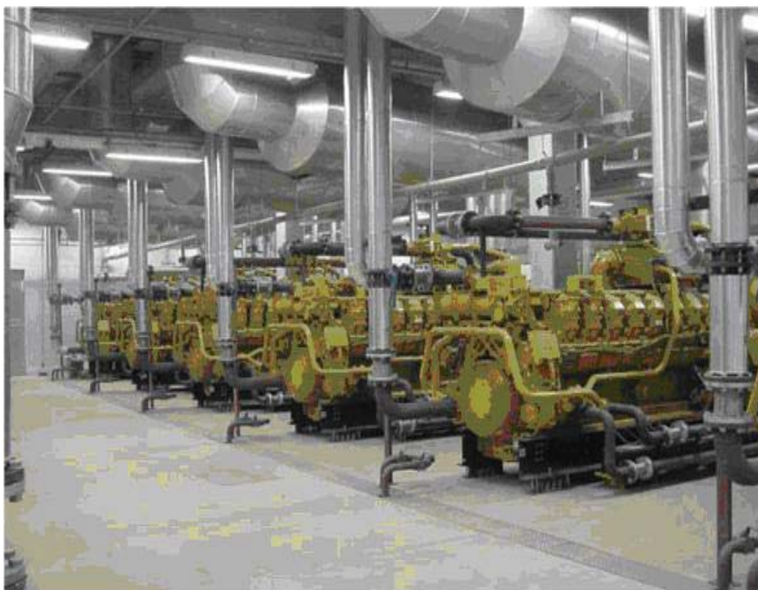
Figura 5.8.3a - Aterro Bandeirantes – Moto-geradores
