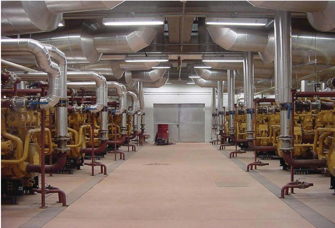
Figura 5.8.3b - Aterro Bandeirantes – Moto-geradores
