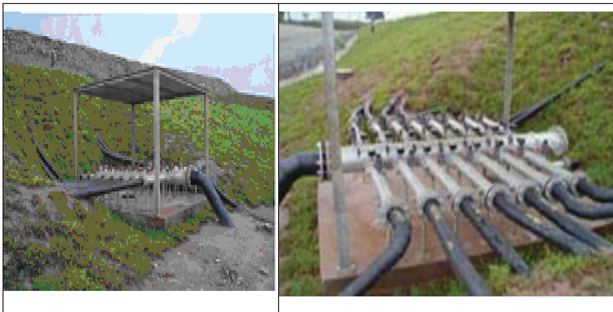
Figuras 5.8.2(a e b). Entroncamentos do Sistema de Coletores do GAS – Aterro Bandeirantes/SP.
