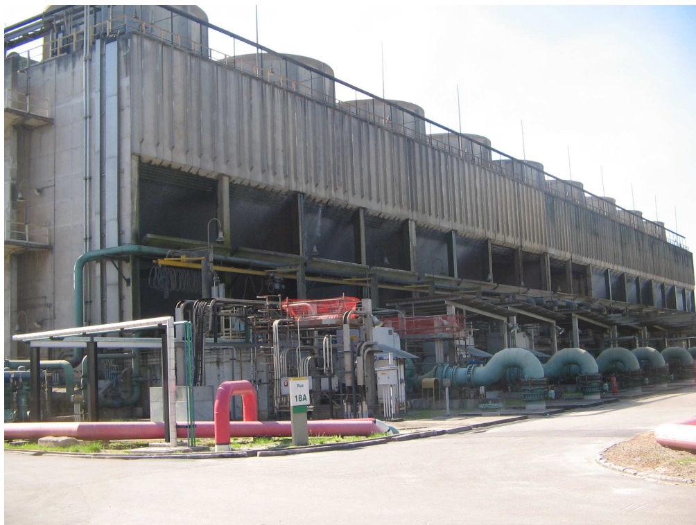
Figura11: Torre de Refrigeração. Fonte: Petrobras (2006).
