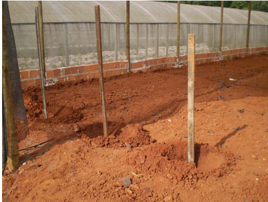
Figura 9 – Delimitação dos canteiros e instalação das coberturas com plástico preto ( mulching ), nos ambientes protegidos, realizadas no dia 30/07/08
