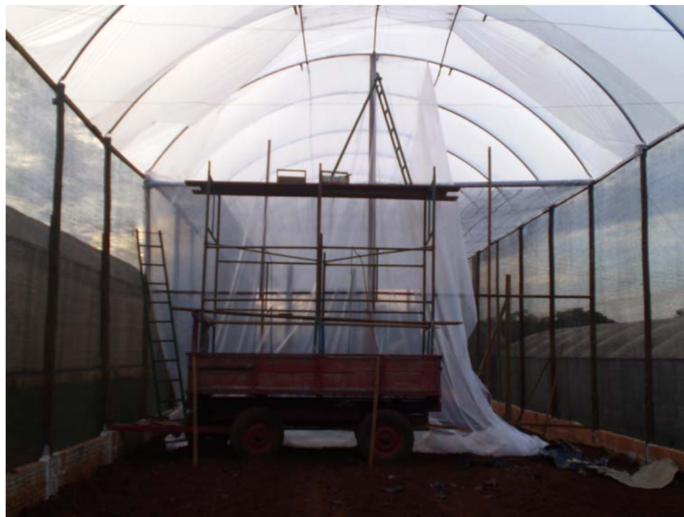
Figura 2 – Instalação do plástico de polietileno de baixa densidade (PEBD) para a divisão do ambiente protegido
