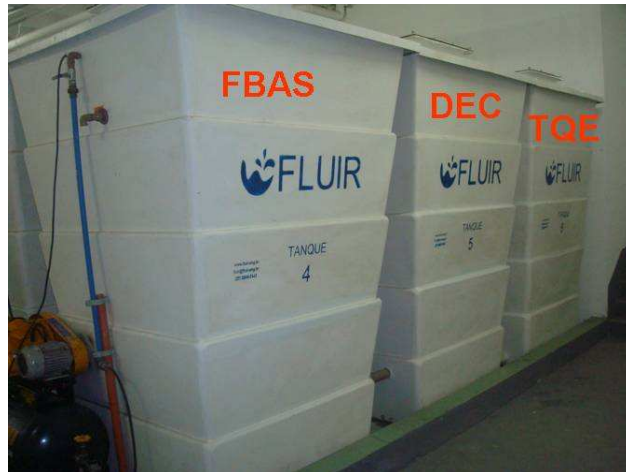
Figura 13: Tanque de Equalização de Vazão
