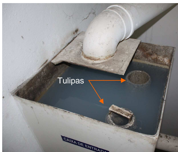
Figura 9: Caixa de entrada de água cinza bruta
