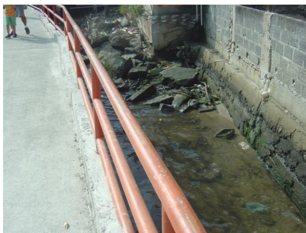
Figura 202: Saída de esgoto de uma edificação (cano à direita) Fonte: Arquivo pessoal, 2008.
