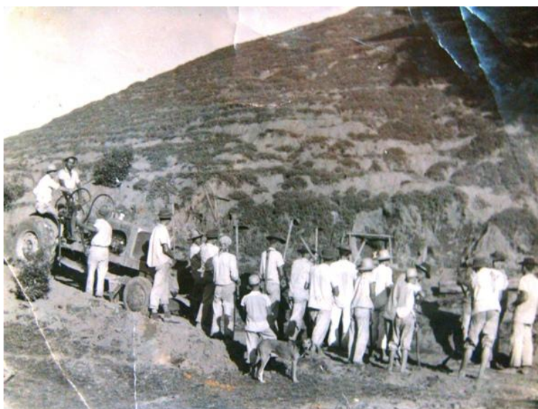
Figura 95: Mutirão para abertura de estrada, em Santa Leopoldina – data e autor não identificados 67
