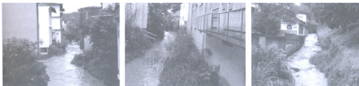
Figura 109: Sede Municipal de Santa Tereza – edificações junto ao curso d’água Fonte: SILVA, 2007, p. 179.
