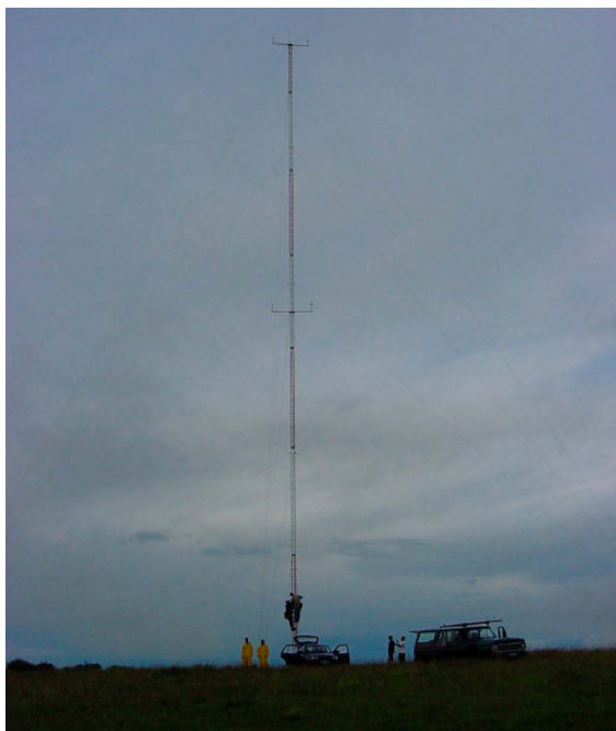
Figura 9 – Instalação de uma das torres anemométricas no Rio Grande do Sul para a elaboração do primeiro Atlas Eólico do Estado.
