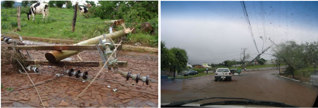
Figura 2 – Danos ocorridos na rede elétrica devido à atuação dos ventos fortes no dia 01/11/2007 em Três de Maio.
