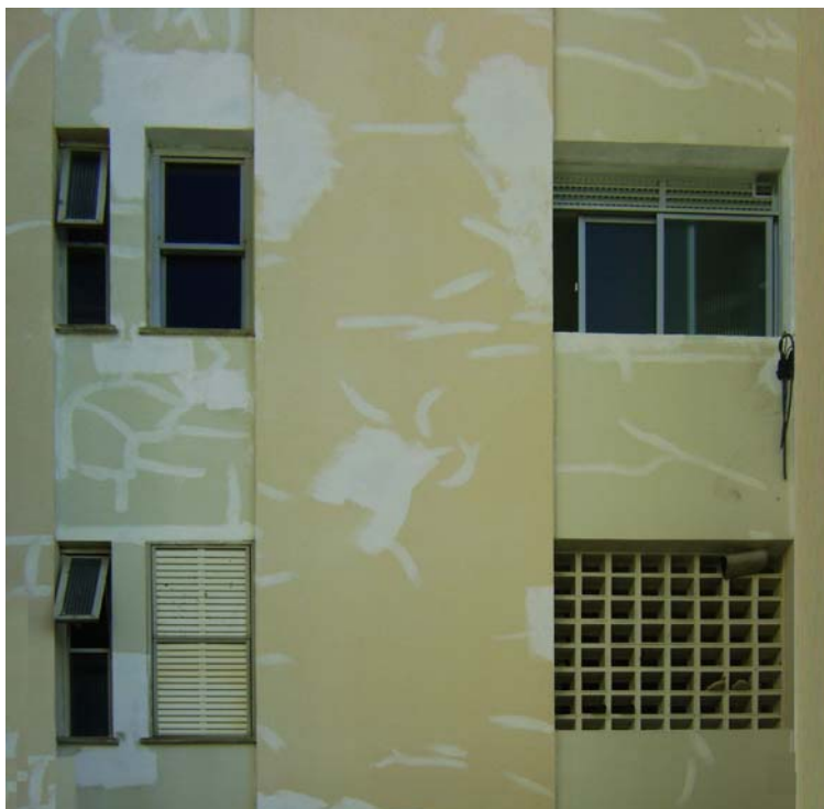
Figura 4.27. Vista das esquadrias da área de serviço da fachada Leste e Oeste
