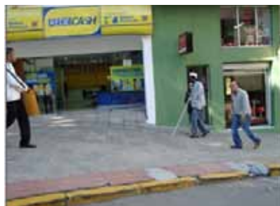
Figura 43: Alargamento da calçada sem piso direcional.
