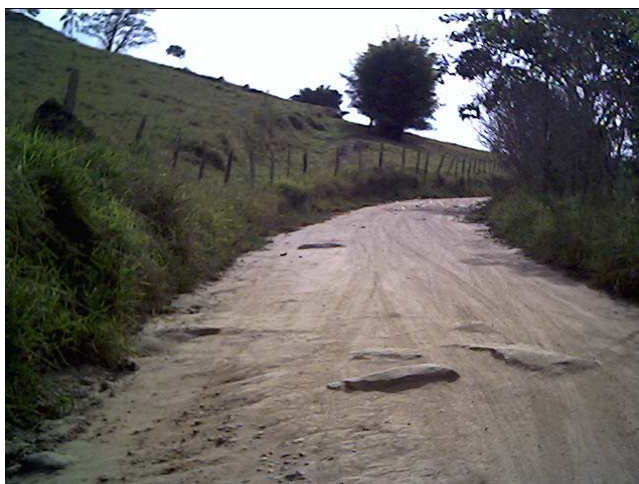
Imagem 11 – Detalhe da estrada de terra, com afloramento de rocha no leito carroçável no interior da bacia hidrográfica do Ribeirão Fartura.
