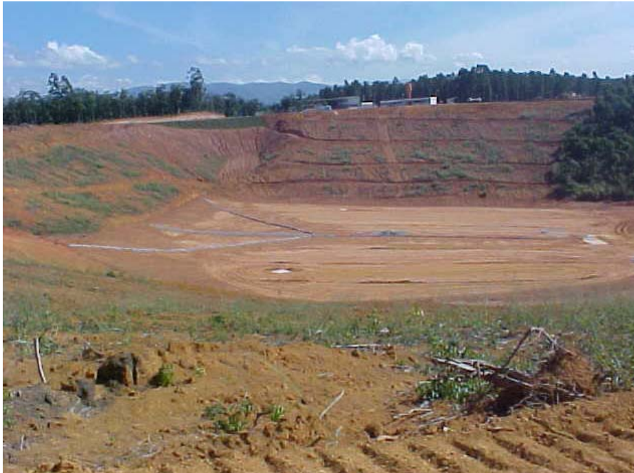
Figura 10 – Vista dos drenos instalados no formato “espinha de peixe” para captação de chorume. Fonte: CRVA (acervo fotográfico) / 2003
