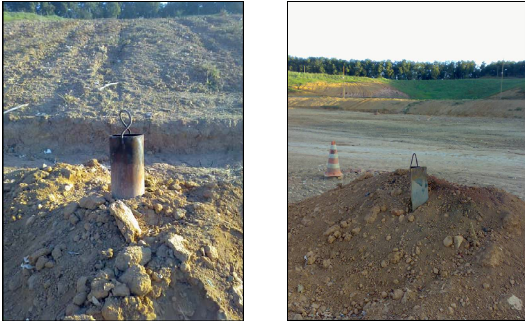
Figura 20 – Aspecto visual dos drenos de gás do aterro sanitário fixados com material de cobertura
