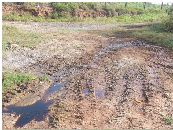
Figura 5.16: Afloramento de chorume próximo ao limite sul do aterro.
