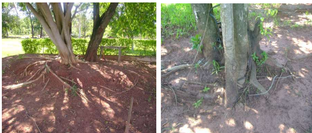
Fotos 13 e 14: Erosão e desbarrancamento às margens do Ribeirão no loteamento Bom Jardim Souza – 12/2006
