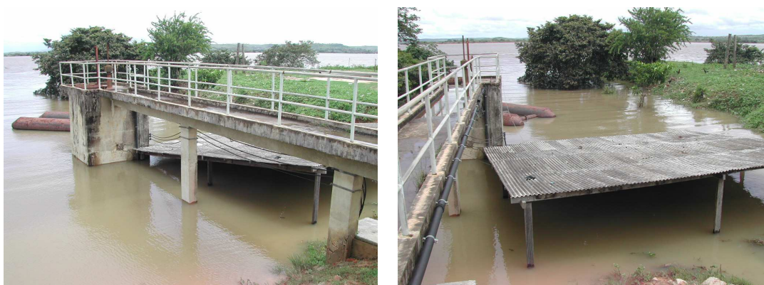
FIGURA 43. Estação de bombas inundada no Perímetro Irrigado Cotinguiba-Pindoba durante a Cheia de 2004 (LABS, 2004).
