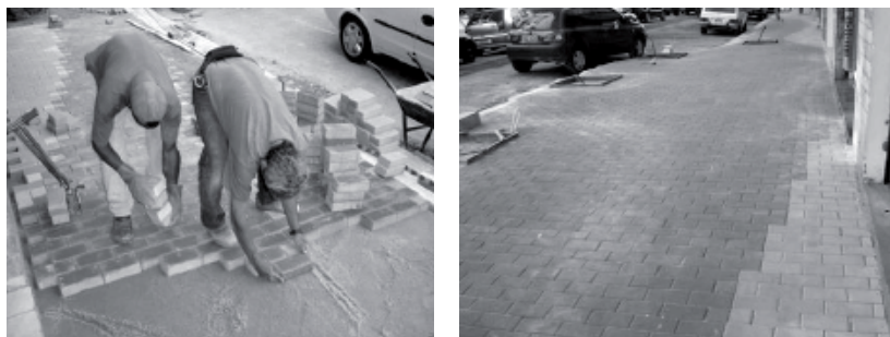
Figura 82: Ilustrações de pavimento intertravado de concreto, durante o assentamento e o revestimento finalizado.
