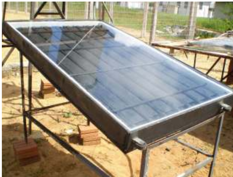
Figura 3.7. Coletor para aquecimento de água montado.
